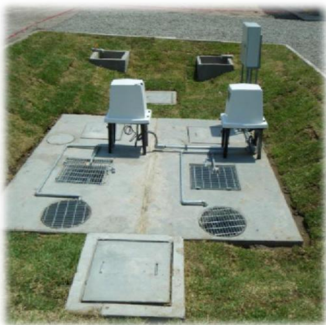
Imagen No. 47. Planta de Tratamiento Terminada Fuente: www.google.com
