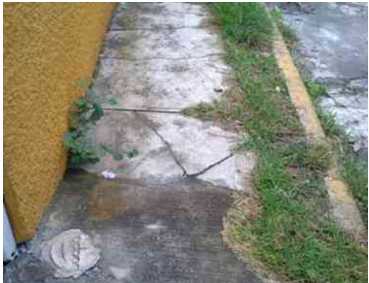
Ilustración 44: Se aprecia el deterioro que existe en la vialidades
