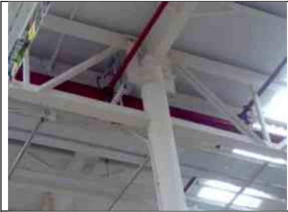
Imagen 4.5, Columna tubular de acero. Fuente: Fotografía del autor.
