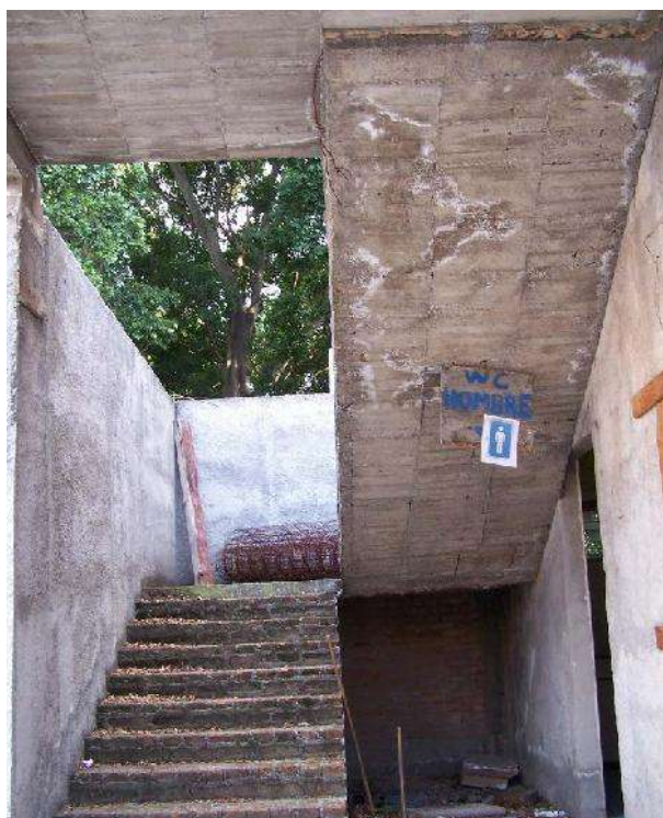
Fotografía 10.- Vista de la escalera actual y la entrada a los baños de hombres Foto: Mireya Ayala Hernández. (2013)
