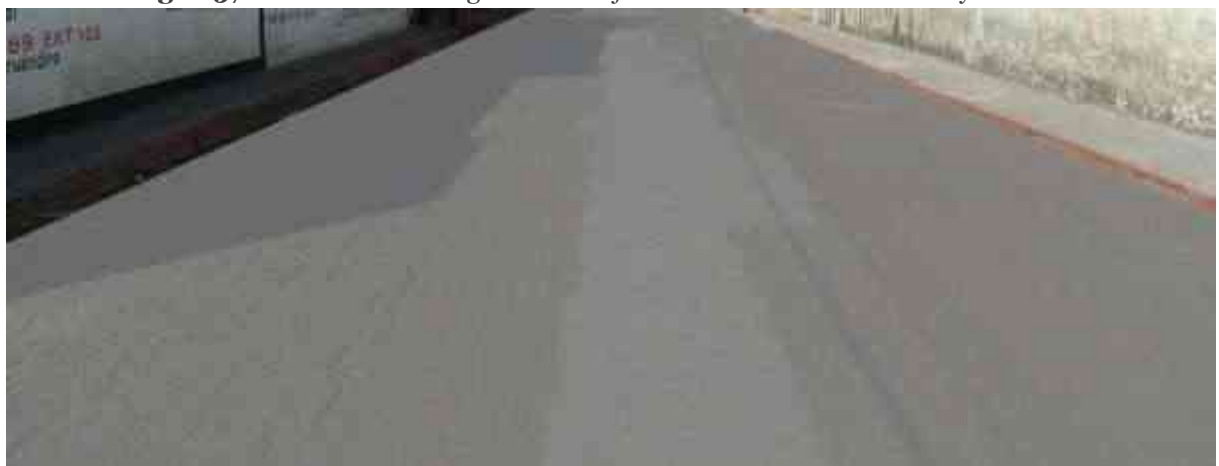
Imagen 58 Pavimentación en toda las calles cercanas al predio, sin embargo presentan serios problemas de deterioro.
