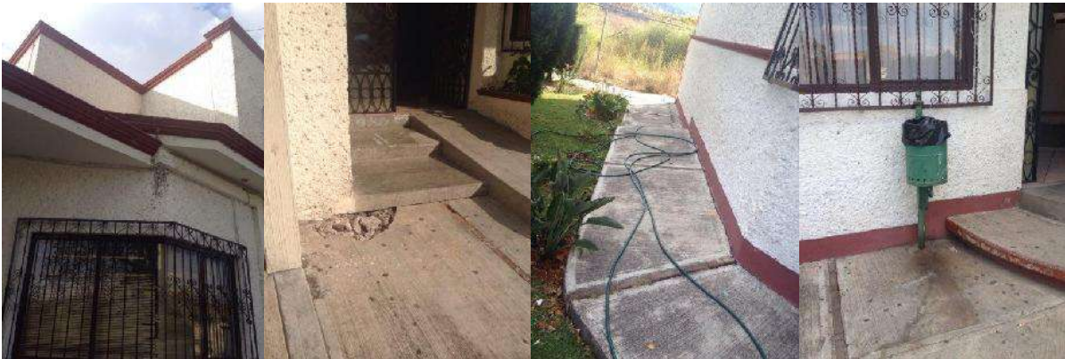
Imagen 11, 12,13 y 14: Imágenes del interior y el exterior del edificio en donde se puede apreciar el estado en el que este se encuentra. El edificio sufre de algunas rupturas en sus losas, banquetas en mal estado y deterioro en sus acabados. © Rosa María Moreno Montoya, 2013.
