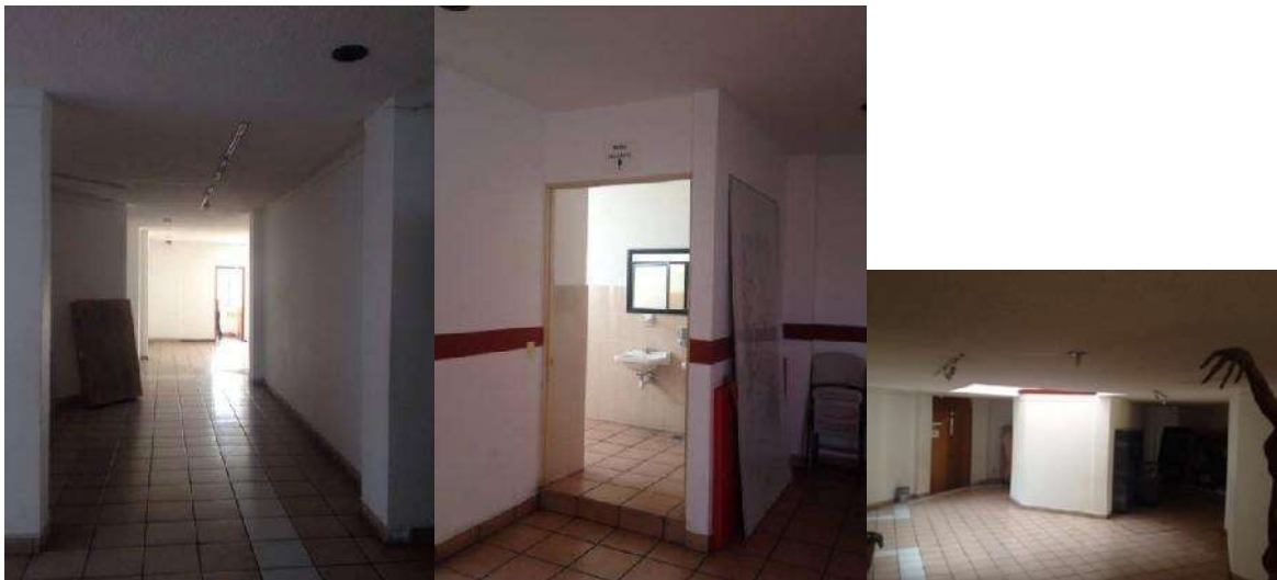
Imagen 15, 16 y 17: El edificio cuenta con muy poca iluminación natural en el interior, el cual ha provocado el uso excesivo de iluminación artificial.
