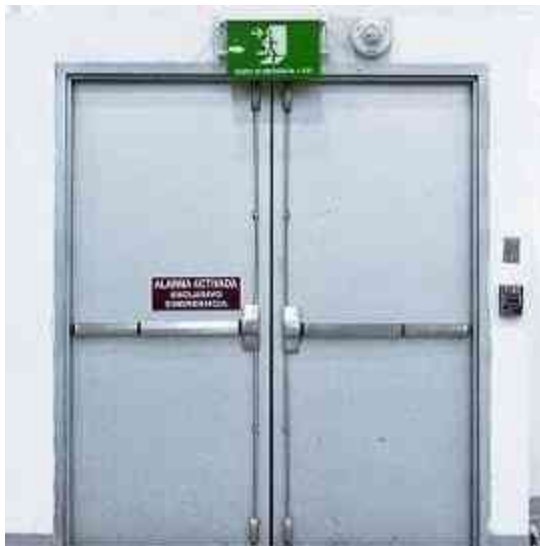
Imagen 58.-Puerta de Salida de emergencia
