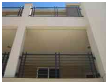
Imagen 52. Guardrail fabricado con material solido.
