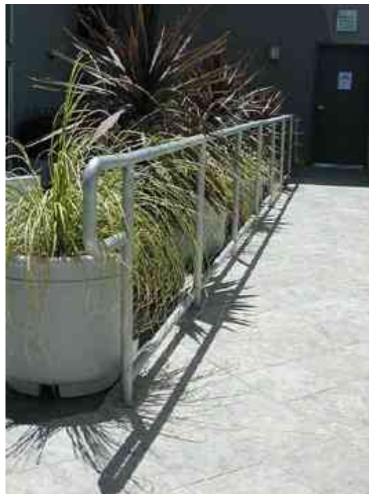
Imagen 60. Pasamano fabricado con tubo redondo de 1\frac{1}{2} " y un rail, en la parte inferior, que sirve como guía para las personas con capacidades diferentes.
