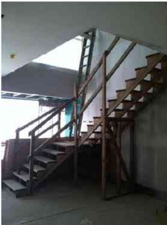
Imagen 2. Vivienda ubicada en 34 Laurel Street, San Francisco Ca. / Escalera Principal antes del trabajo realizado.
