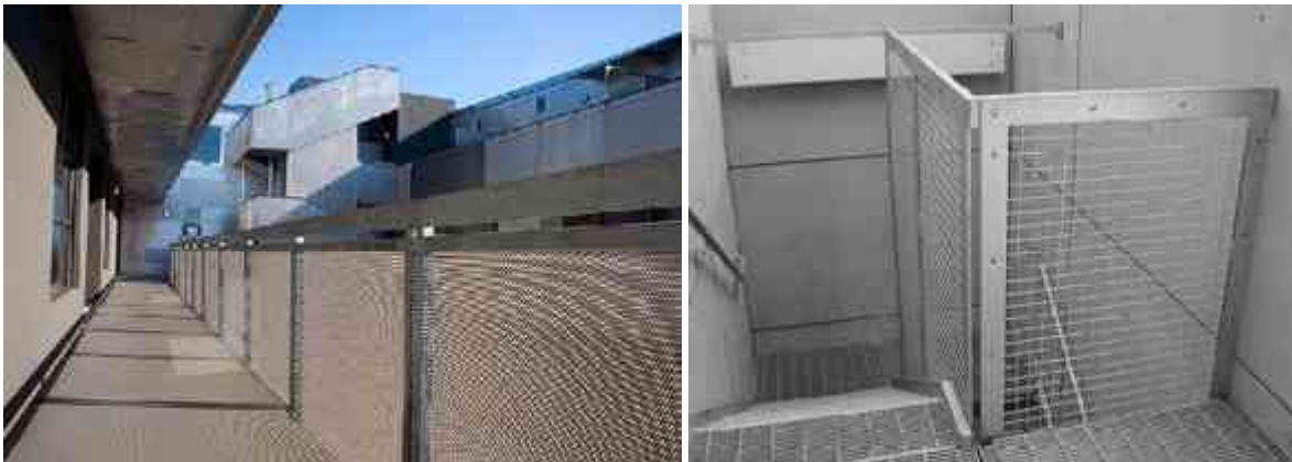
Imagen 39 (Izquierda). Guardrail fabricado con material tubular y paneles de lámina perforada, para cerrar el espacio a menos de 4". Imagen 40 (Derecha). Guardrail fabricado con material tubular y paneles de malla, para cerrar el espacio a menos de 4".
