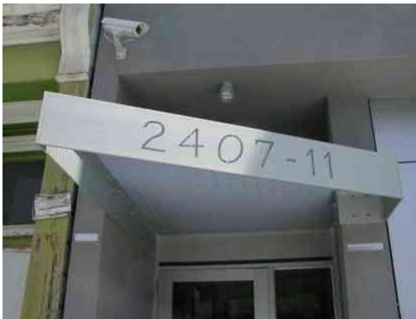
Imagen 83. Canopy formado con estructura de solera con grating (rejilla) de aluminio.
