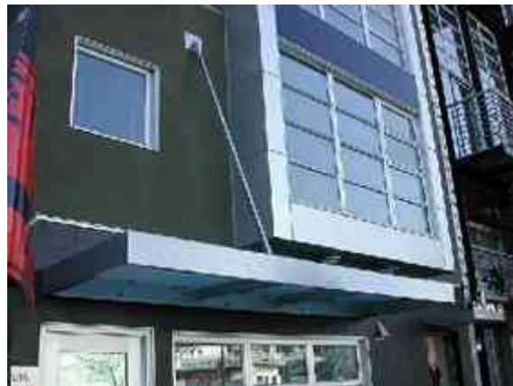
Imagen 87. Canopy formado de estructura de canal y soportes intermedios, de material tubular que reciben unos paneles de cristal; cuenta con un tensor para brindar soporte adicional.
