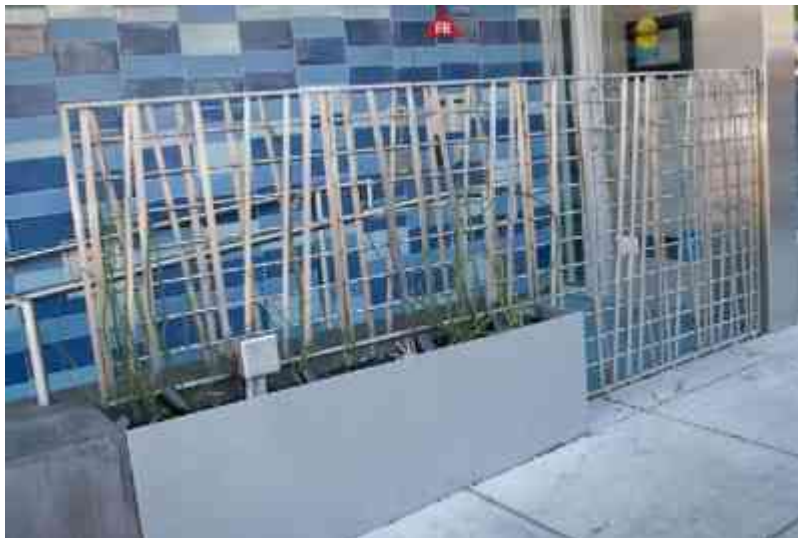
Imagen 77. Defensa fabricada con material sólido, como barras horizontales de \frac{1}{2} " y soleras de 1\frac{1}{2} " y \frac{3}{4} " de ancho por \frac{1}{4} " y \frac{3}{8} " de grueso.
