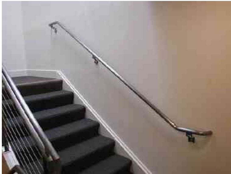
Imagen 58. Pasamano fabricado con tubo redondo de 1½" de acero inoxidable, sujeto a la pared por medio de brackets prefabricadas.
