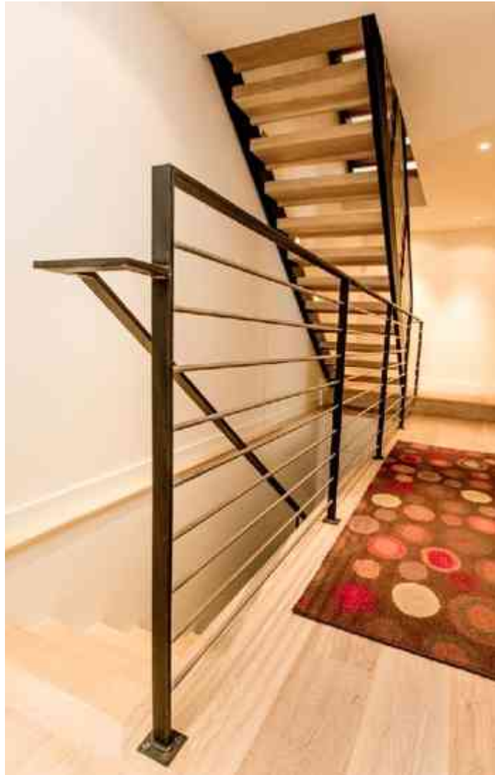
Imagen 36. Guardrail con rails de barra sólida de \frac{1}{2} " de diámetro. (Sin bottom rail)
