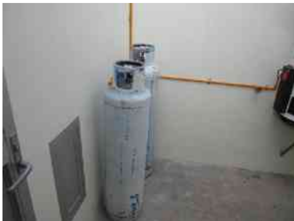
Fig.116 - Tanques de Gas de 30 Kg. cada uno
