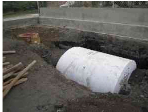
Fig. 91 - Pozo de visita a la salida de la planta tratadora, antes de la descarga.
