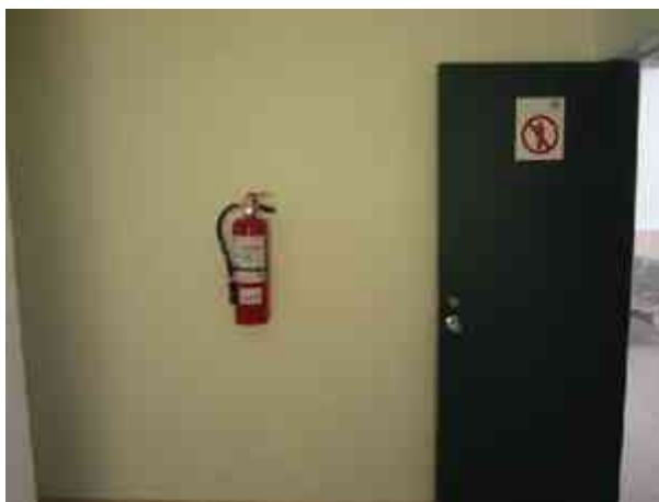
Fig. 140 - Acceso restringido hacia la residencia medica.
