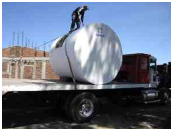
Fig.88 - Suministro de planta de tratamiento de aguas negras prefabricada, solicitado por las autoridades municipales.
