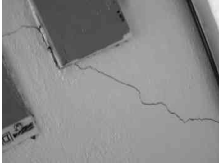
Img. 16 - Fractura diagonal en muro originada por asentamiento del terreno natural.
