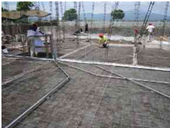
Fig. 102 - Canalización del tablero principal de distribución hacia las distintas áreas.
