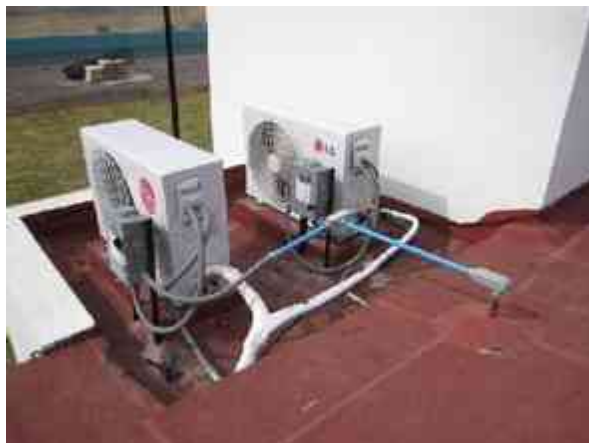
Fig. 126 - Unidades condensadoras de equipos Mini Split de Sala de usos múltiples y Recuperación.
