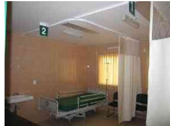
Fig. 83 - Falso plafón con luminarias de circuito normal y de emergencia, con cortinas antibacterianas.
