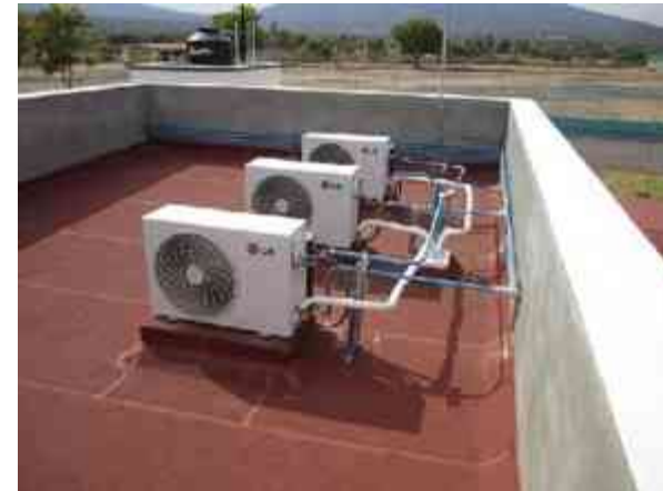
Fig.125 - Unidades condensadoras de equipos Mini Split de Vestíbulo y Medicina preventiva.
