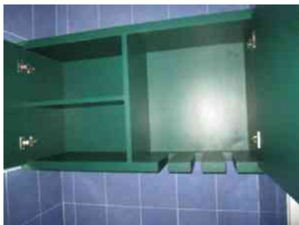
Fig. 62 - Guarda de Aseo.
