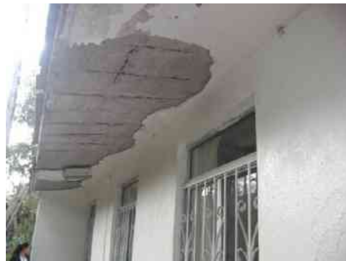
Img. 11 - Desprendimiento de aplanado en marquesina, dejando el acero expuesto, ocasionando oxidación.
