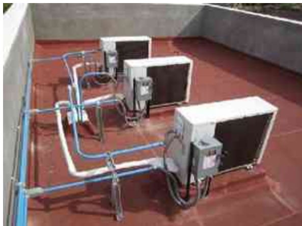
Fig.108 - Alimentadores de las Unidades Condensadoras con interruptor de cuchilla.
