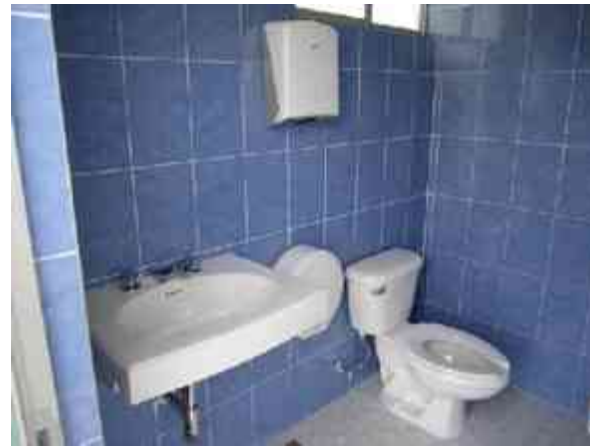
Fig. 75 - Muebles sanitarios y accesorios de baño, sanitario C.A.R.A.
