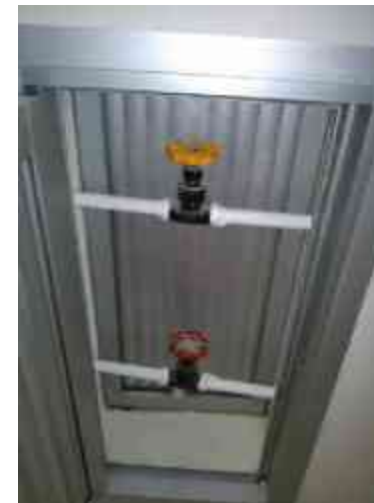
Fig.99 - Cuadro de válvulas para seccionamiento del fluido por áreas, en caso de que se requiera hacer alguna reparación.
