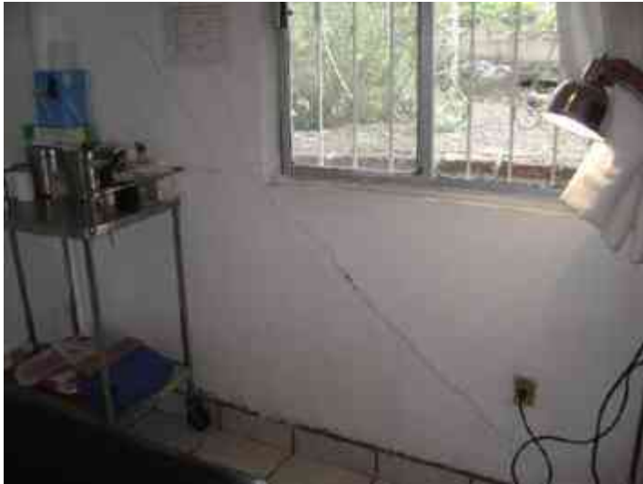
Img. 12 - Fractura diagonal en muro originada por asentamiento del terreno natural.
