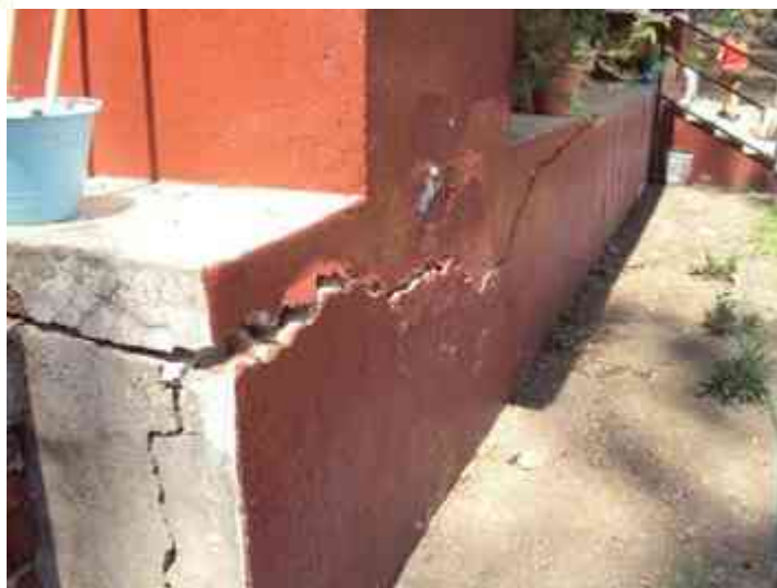
Img. 08 - Fractura en muro de enrase y separación del firme.
