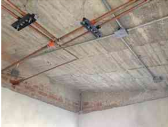
Fig.96 - Instalación hidráulica sobre soportaría colganteada con taquete expansivo para perno de 3/16", varilla roscada de 3/16".
