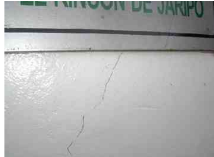
Img. 19 - Grieta por asentamiento del terreno natural en muro de fachada de acceso.
