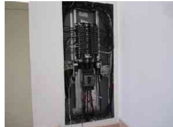
Fig.105 - Peinado de tablero principal de distribución.
