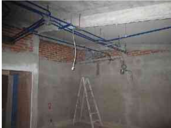
Fig.104 - Canalización para instalación eléctrica, identificada por la aplicación de esmalte color azul.
