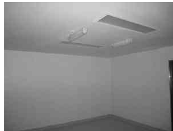
Fig. 151 - Luminarias de emergencia en Sala de procedimientos Mixtos en caso de un corte a la energía.
