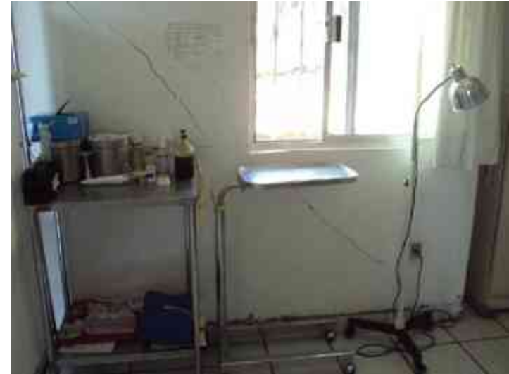
Img. 13 - Fractura diagonal en muro originada por asentamiento del terreno natural.
