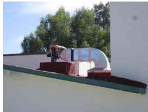
Fig.121 - Ductería y extractor de aire en azotea.
