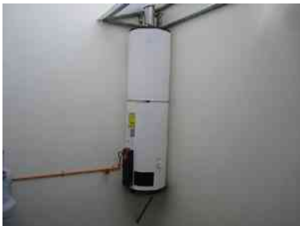
Fig. 144 - Calentador de 105 Lts ubicado en el patio de servicio.
