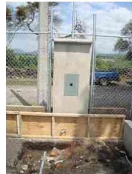
Fig. 103 - Interruptor principal de alimentación.
