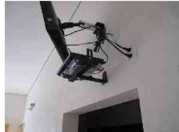
Fig. 107 - Contactos para conexión de equipos de TV y DVD.
