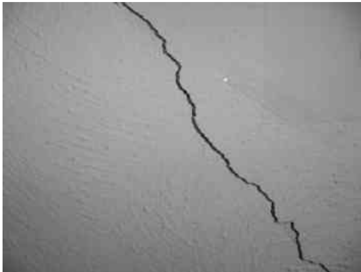
Img. 14 - Acercamiento de grieta en muro.
