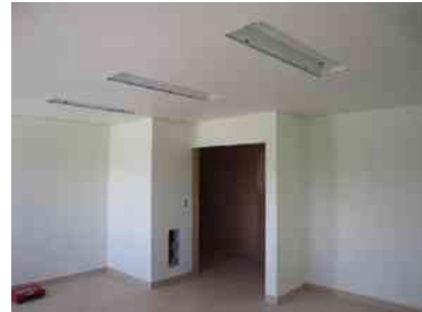
Fig.81 - Huecos en plafón para colocación de luminarias.
