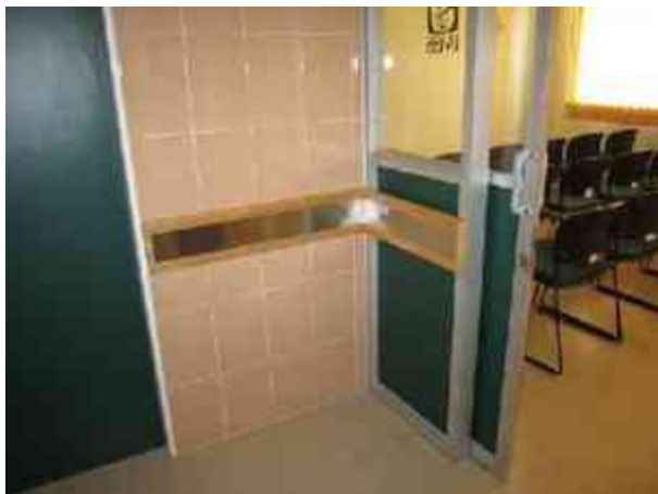
Fig. 160 - Protección contra camillas, a base de pieza de madera con lámina de acero inoxidable.
