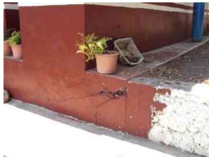
Img. 07 – Fractura en muro de enrase de cimentación por asentamiento del terreno natural.
