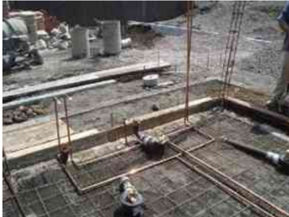
Fig.92 - Tubería de cobre tipo M de \frac{1}{2} " de diámetro.
