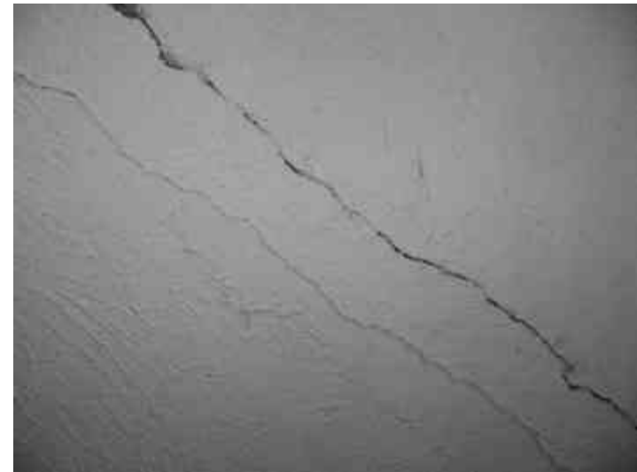
Img. 15 - Acercamiento de grieta en muro.
