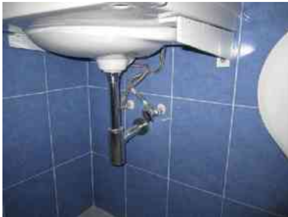
Fig.98 - Válvulas angulares para alimentación de lavabo.
