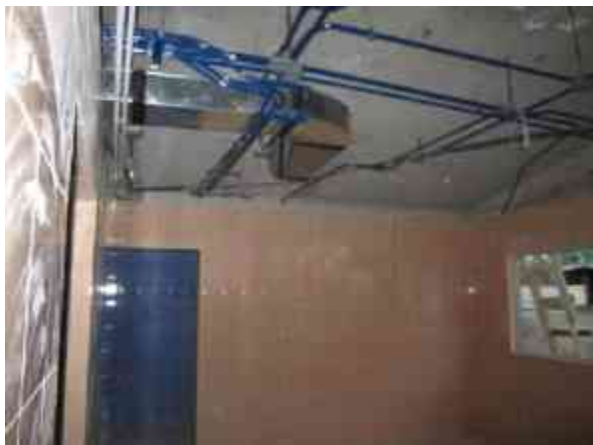
Fig.120 - Ductería de extracción de aire de sala de procedimientos mixtos hacia azotea.
