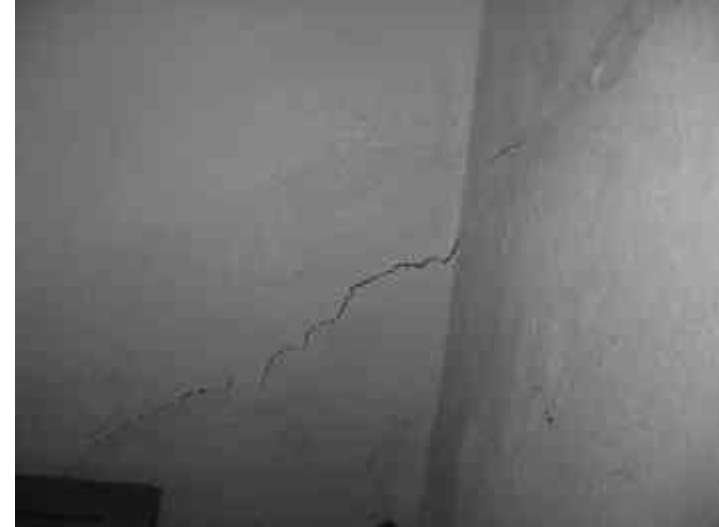
Img. 17 - Fractura diagonal en muro originada por asentamiento del terreno natural.
