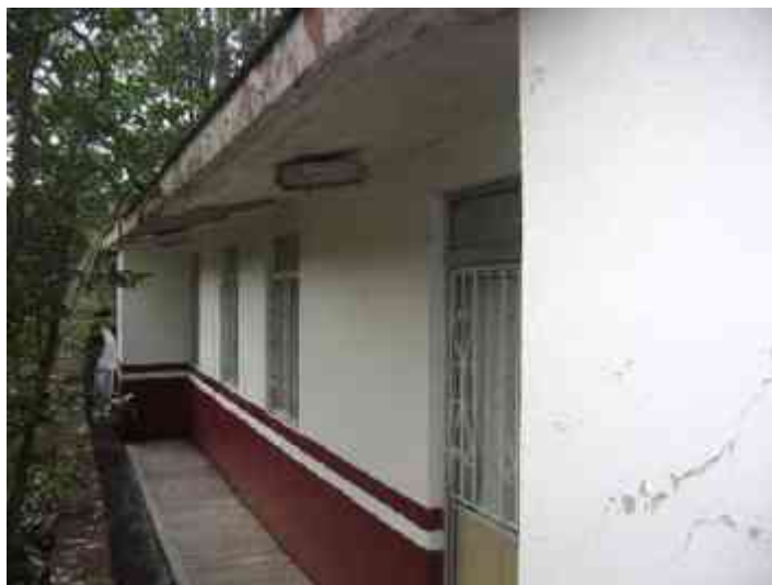
Img. 10 - Humedad en losa por deterioro en impermeabilizante.
