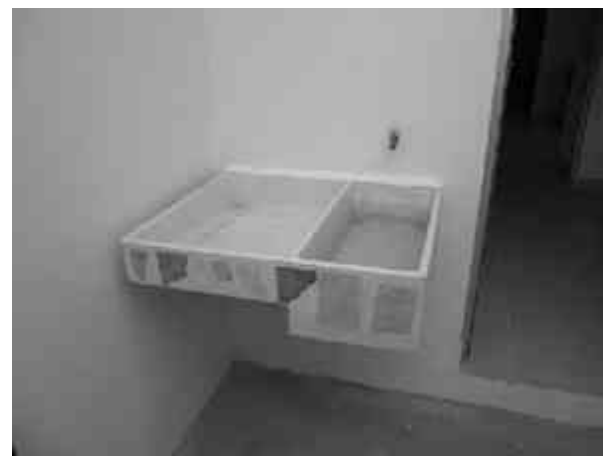
Fig.145 - Patio de servicio equipado con lavadero.
