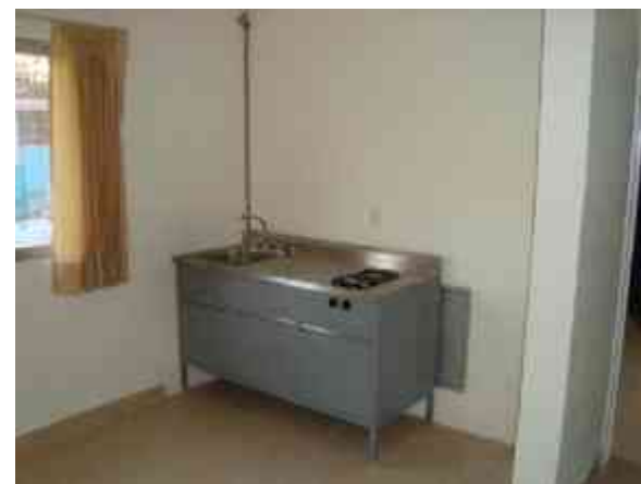
Fig. 119 - Conexión de Parrilla en cocineta de residencia medica.
