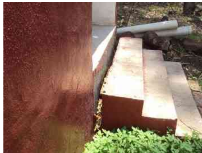
Img. 09 - Separación de escaleras por asentamiento del terreno natural.
