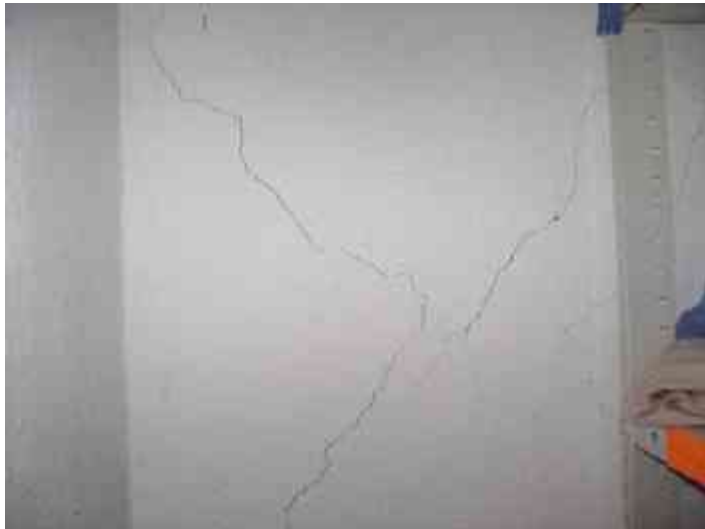
Img. 18 - Grieta en muro por asentamiento del terreno natural.
