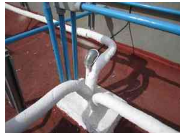
Fig. 127 - Paso de Tuberías de líquido refrigerante de las unidades Condensadoras hacia las evaporadoras.
