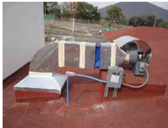
Fig. 109 - Alimentación eléctrica de extractor de Sala de Procedimientos mixtos con interruptor de cuchilla.
