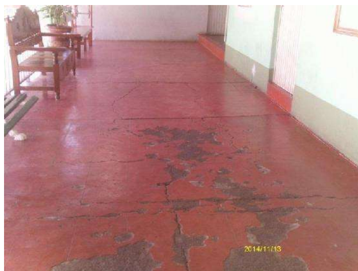
Ilustración 2. Losa de entrepiso del Palacio Municipal fracturada. J.M.U.T.
