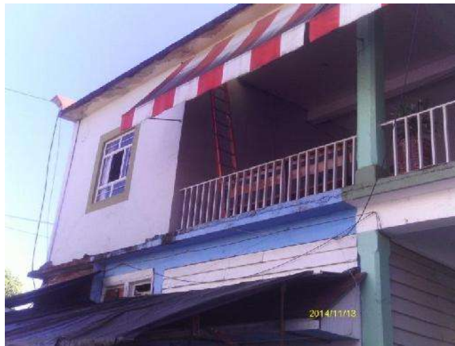
Ilustración 3. Instalaciones eléctricas improvisadas. J.M.U.T.
