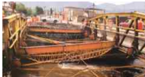
IMAGEN 3. AFECTACIONES DE UN PUENTE IMPORTANTE EN TUXPAN, FUENTE. JORGE RIVERA, MAYO 2015
