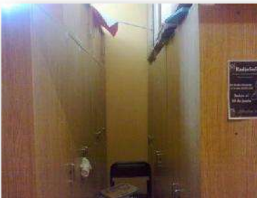
Imagen 50.- Fotografía de la fonoteca encierra humedad debido a la temperatura que tiene y el material del que está recubierta, es un pequeño pasillo de 60cm. Por Juan A. Camarillo León.
