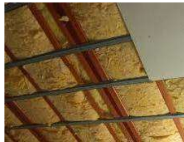
Imagen 151.- Tratamiento acústico en plafón en cabinas de locución y grabación. Fotografía por Juan A. Camarillo León.
