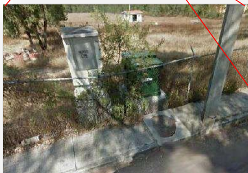
Imagen 29.- Medidor de CFE en los linderos del predio. Registro para acometida y líneas de alta tensión sobre banqueta, transformador.
