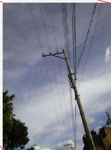
Imagen 31.- Cableado eléctrico, poste de C. F. E.
