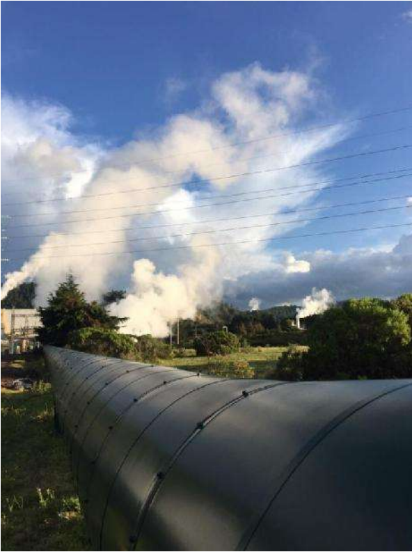
Fig. 127 Ductos, tomada por GLP, el 21 de Mayo de 2015.
