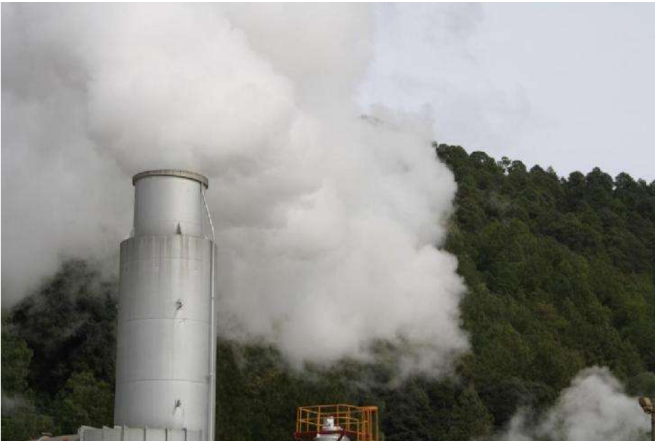
Fig. 77 Extracción de vapor en pozos Geotérmicos, Volcán de San Andrés, tomada por GLP 12-Ene-2015
