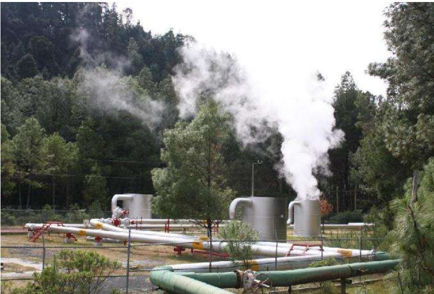
Fig. 126 Extracción y ductos de Vapor, tomada por GLP, el 8 de Enero de 2015.
