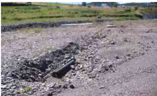
Imagen 48. Red de Alcantarillado y Drenaje Foto: Jonnathan M. Morales Camacho. [17/10/2014)
