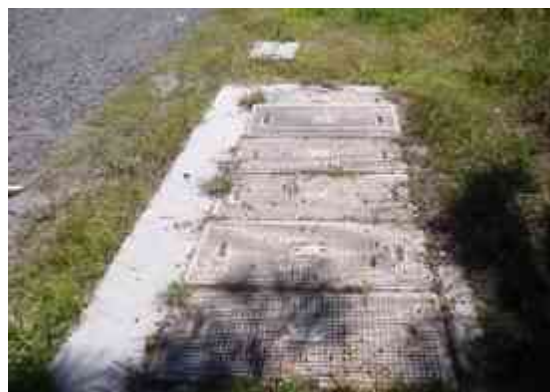
Imagen 49. Registros de Telefonía e Internet Foto: Jonnathan M. Morales Camacho. [17/10/2014)
