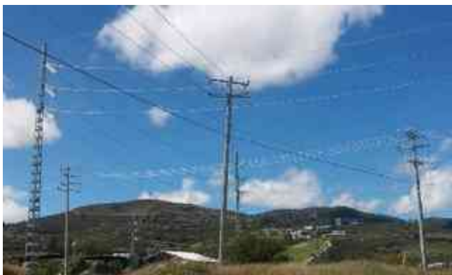
Imagen 46. Red Eléctrica de Alta y Baja Tensión Foto: Jonnathan M. Morales Camacho. [17/10/2014)
