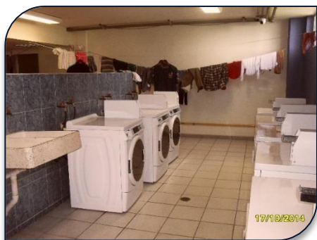
Imagen 17. Área de lavado de uso en común. Tecnológico de Monterrey, campus Querétaro. Qro. Fuente: fotografía capturada por el autor.
