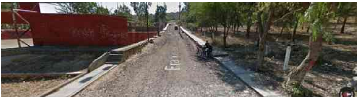
Ilustración 27. Estado actual de pavimentos.
