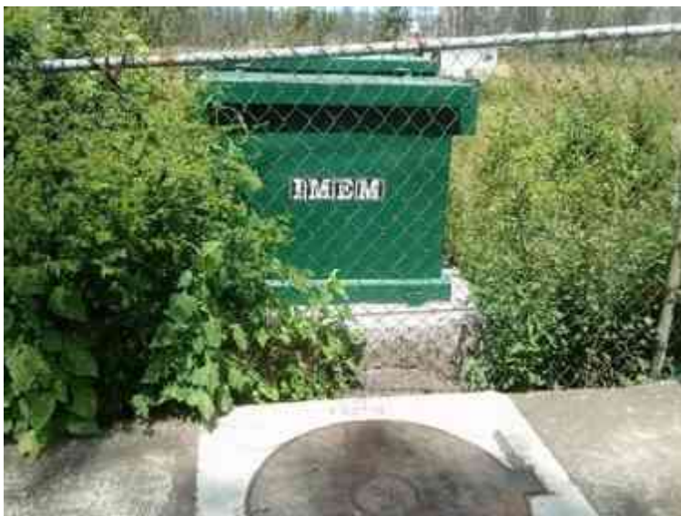
Imagen 86: transformador de alto voltaje ubicado a un costado del acceso principal del predio Fotografía tomada por: Ricardo Cruz Porras
