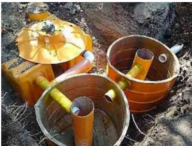
Imagen 84: Biodigestor o Fosa séptica implementada en el CIDAM y el campus de la UNAM. Fotografía tomada por Ricardo Cruz Porras
