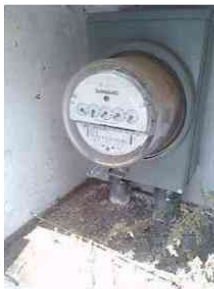
Imagen 87: Medidor de CFE frente al acceso principal del predio. Fotografía tomada por: Ricardo Cruz Porras
