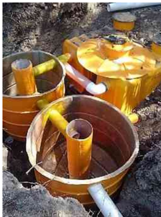
Imagen 85: Biodigestor o Fosa séptica implementada en el CIDAM y el campus de la UNAM. Fotografía tomada por Ricardo Cruz Porras
