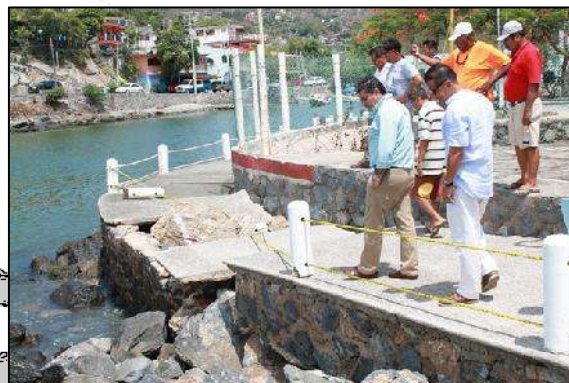
Imagen 24. Daños ocurridos por sismo, muelle de Ixtapa Zihuatanejo. 2014
