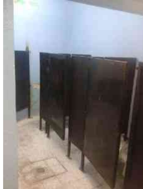
Imagen4 tomada por el autor: En la fotografía se muestran los sanitarios con poca higiene.
