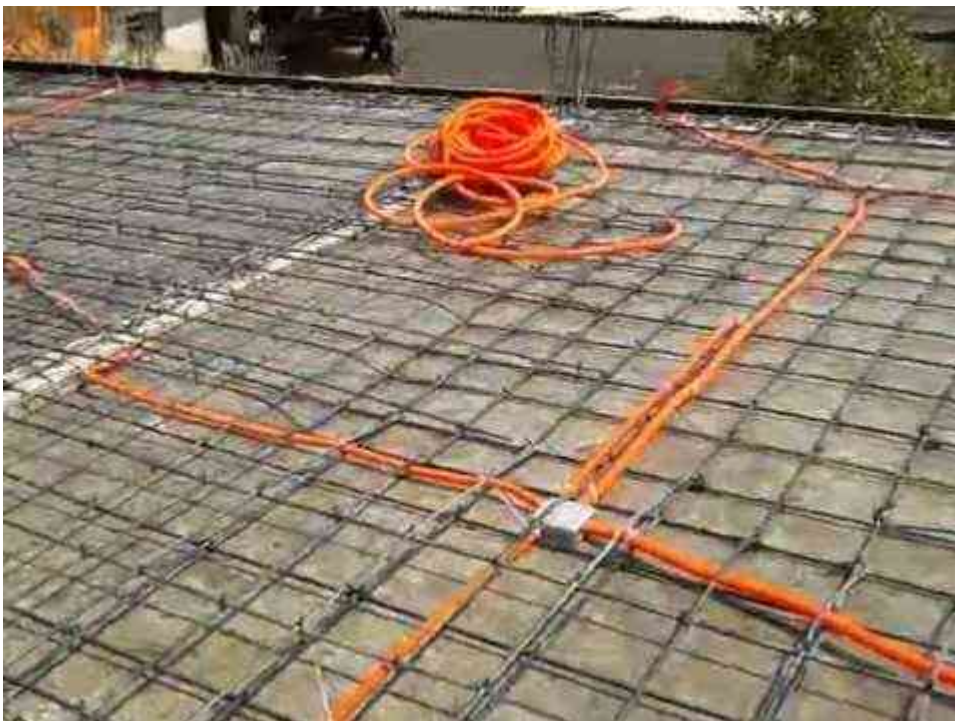
foto 7 instalación eléctrica, se aprecia en la foto el ahogado de la manguera para la instalación eléctrica foto: http://living.com/ii/8uzindIEtM/bgdefault.jpg
