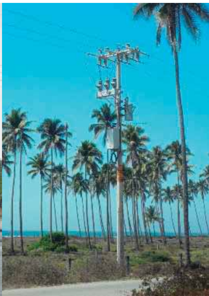
IMAGEN 56. Líneas de cableado eléctrico [Foto: EPGM]
