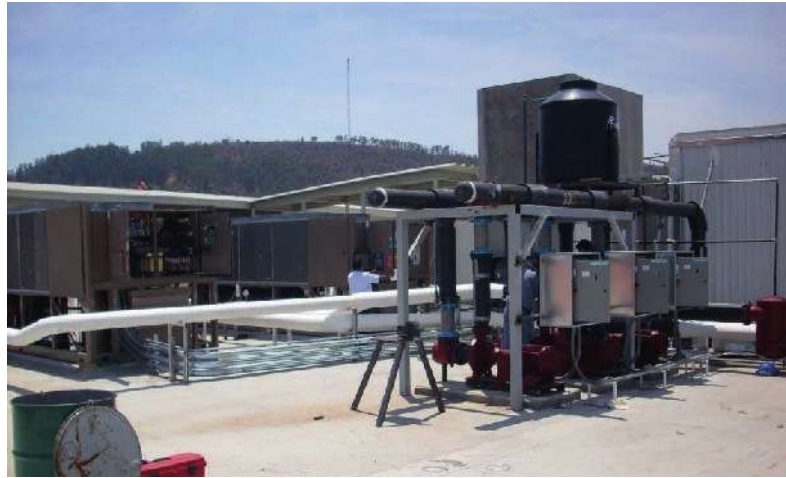
Figura 50 Unidad generadora de agua helada tipo Chiller. Tomada en Plaza las Américas. 7/07/2009. (AEAF)
