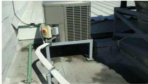
Figura 27 Unidad condensadora de Fan & Coil. Se aprecia que la unidad está apoyada sobre una base de herrera.
