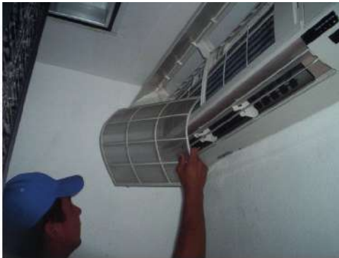
Figura 16 Unidad Condensadora de descarga lateral de Aire acondicionado tipo Mini Split. Tomada en Coca Cola Mega Morelia. 10/Sep/2015 (AEAF). En la foto podemos apreciar las unidades condensadoras instaladas en forma lineal lo cual facilita la instalación de la tubería de cobre y descarga de dren a la baja de agua pluvial.
