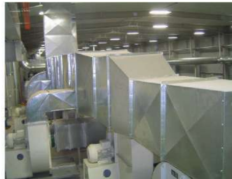
Figura 61 Ductos de Lámina Galvanizada. Tomada en Línea 4 Treofán México, Zacapu, Mich. 4/Dic/2016 (AEAF)
