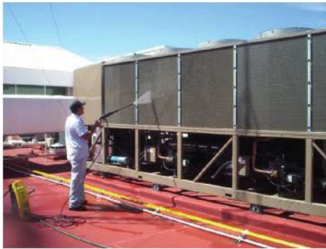
Figura 51 Mantenimiento a Unidad tipo Chiller, limpieza de gabinete a presión de agua. Tomada en Plaza Las Américas. 18/Feb/2010 (AEAF)
