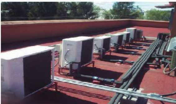
Figura 13 Unidad Condensadora de descarga lateral de Aire acondicionado tipo Mini Split. Tomada en Coca Cola Mega Morelia. 10/Sep/2015 (AEAF). En la foto podemos apreciar las unidades condensadoras instaladas en forma lineal lo cual facilita la instalación de la tubería de cobre y descarga de dren a la baja de agua pluvial.
