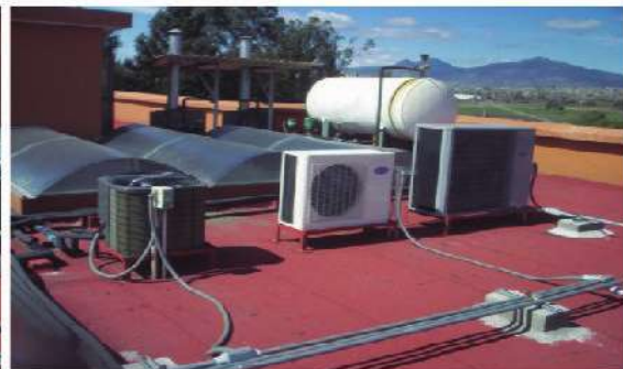
Figura 14 Unidad Condensadora de descarga Vertical de Aire acondicionado tipo Mini Split. Tomada en Coca Cola Mega Morelia. 10/Sep/2015 (AEAF). En la foto se puede apreciar una unidad de descarga vertical.
