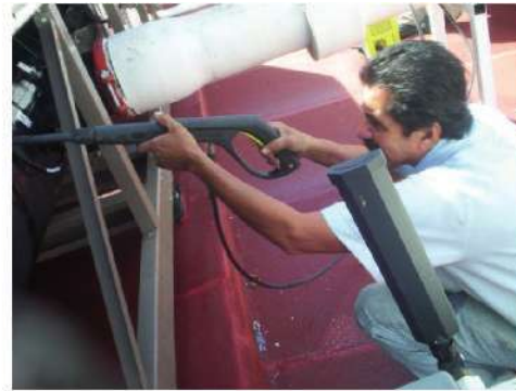
Figura 52 Mantenimiento a Unidad tipo Chiller, limpieza del interior del gabinete a presión de agua. Tomada en Plaza Las Américas. 18/Feb/2010 (AEAF)
