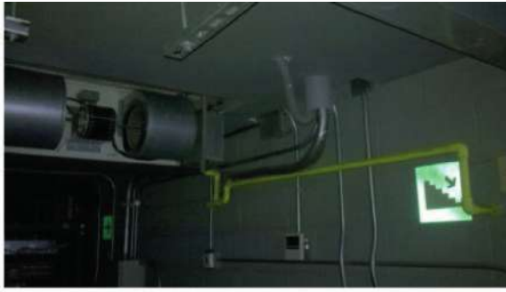
Figura 25 Unidad evaporadora de Fan & Coil, vista posterior. Se aprecia el dren PVC en color amarillo, tubería de cobre forrada con rubatex. 14
