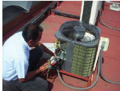
Figura 67 En la foto puede apreciarse como el técnico toma la presión del refrigerante con el manómetro. Tomada en la distribuidora Coca Cola Mega Morelia, 10/Sep/2015. (AEAF).
