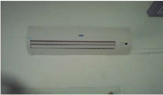
Figura 11 Unidad Evaporadora tipo Hi Wall de aire acondicionado tipo Mini Split. Tomada en Coca Cola Mega Morelia. 10/Sep/2015 (AEAF).
