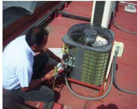
Figura 17 Unidad Condensadora de descarga Vertical de Aire acondicionado tipo Mini Split. Tomada en Coca Cola Mega Morelia. 10/Sep/2015 (AEAF). En la foto se puede apreciar una unidad de descarga vertical.
