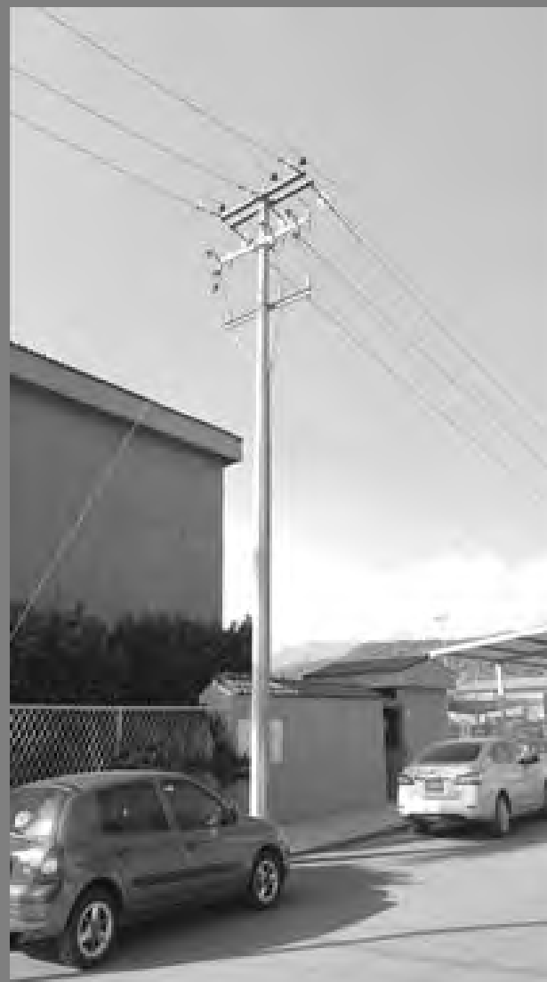
Red eléctrica frente al predio
