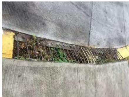
Fotografía 21. Drenaje de agua pluvial en la calle secundaria del predio, tomada por: Ilse Cahue.
