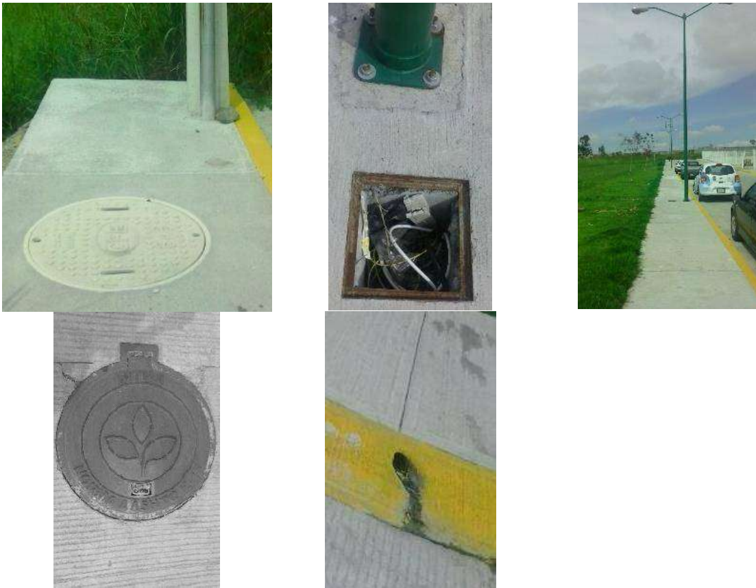
Evidencia de los servicios de infraestructura urbana, 2014. Levantamiento del autor.
