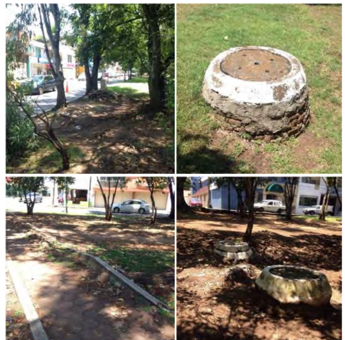
Imagen 11 La problemática es similar y constante a lo largo del boulevard: alcantarillas a desnivel, piso deteriorado, ausencia de pasos peatonales en los cruces. Autor: José Luis Tapia Ayala. Fecha: 20 Febrero 2016
