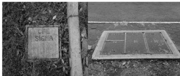
Imagen 51 Registros de CFE (Comisión Federal de Electricidad) y TELMEX (Teléfonos de México). Autor: José Luis Tapia Ayala. Fecha: 10 Marzo 2016.
