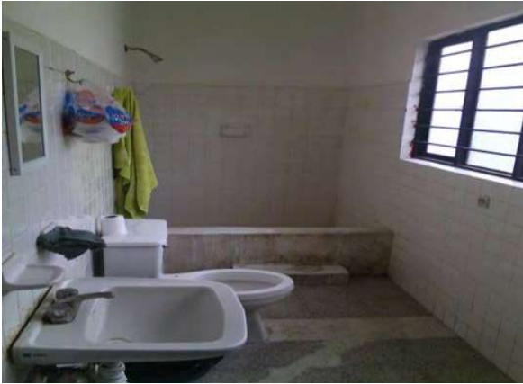
Fotografía 3 baño de estación de policías. (Fuente propia. Fecha 07-02-2016)
