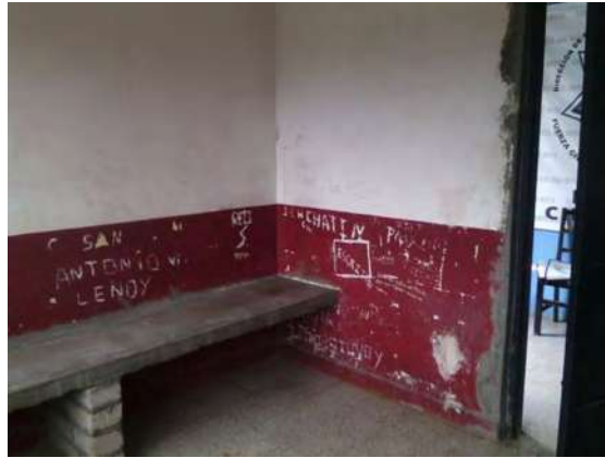
Fotografía 4 barandillas estación de policías. (Fuente propia. Fecha 07-02-2016)
