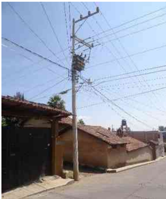
Imagen 92: Ubicación de la señalización de la red eléctrica transformador de voltaje. Fuente: Benjamín Cortes Sebastián. [3/Oct/2015]
