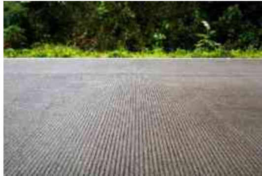
Imagen 117: vista del firme concreto hidráulico, acabado escobillado. Fuente: http://blog.360gradosenconcreto.com/pisos-y-pavimentos-en-concreto-fisuras-por-cambios-dimensionales/ . [28 enero/2017]
