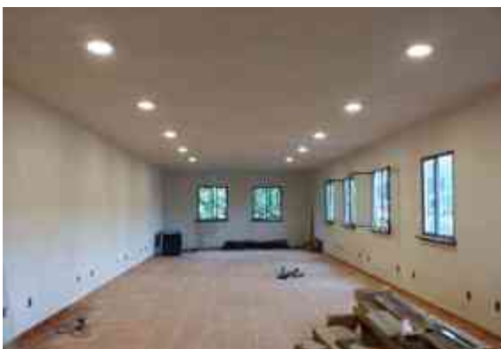
Imagen 89. Vista de las luminarias LED en galerones. (Foto tomada por Karim Alan Corona Hernández).
