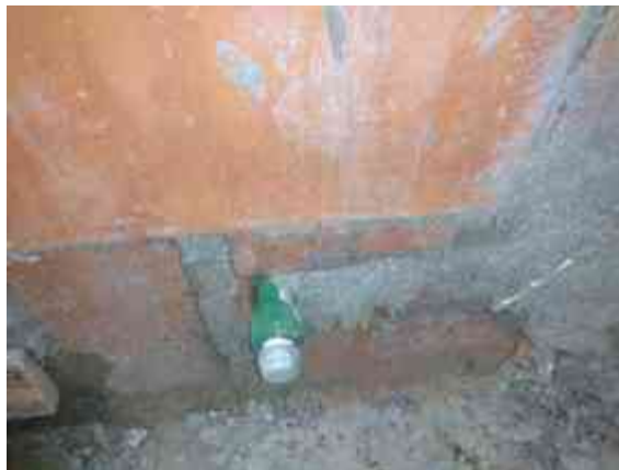
Imagen 72. Vista de salidas hidráulicas. (Foto tomada por Karim Alan Corona Hernández).
