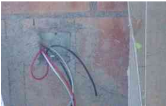
Imagen 79. Cableado de salidas eléctricas. (Foto tomada por Luis Fernando Lara Núñez).
