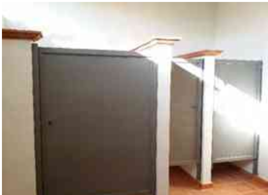
Imagen 91. Vista de las Mamparas de Herrería en Sanitarios. (Foto tomada por Karim Alan Corona Hernández).
