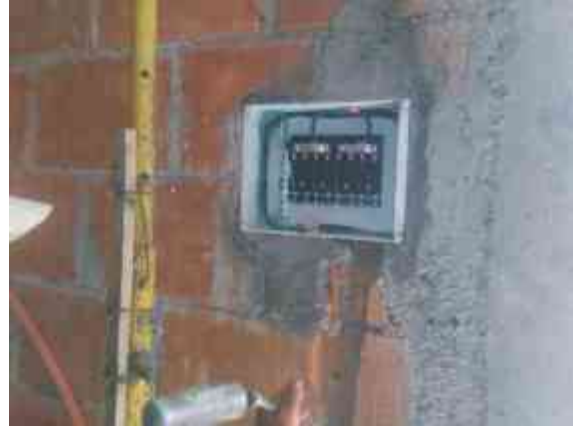
Imagen 77. Centro de Cargas en zona de almacén. (Foto tomada por Luis Fernando Lara Núñez).
