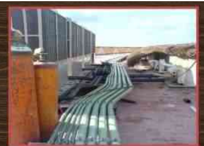
Imagen 3. 242. Tipología de equipos de aire acondicionado instalados.
