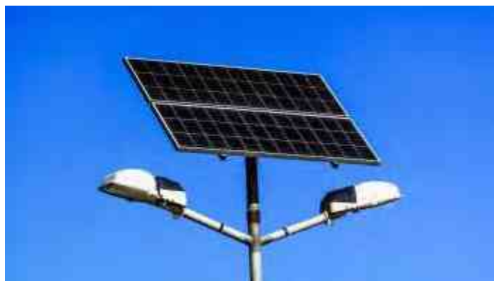
Img. 188 panel solar en alumbrado público, fuente: https://solar-energia.net/definiciones/panel-solar.html , consulta: junio 2017.
