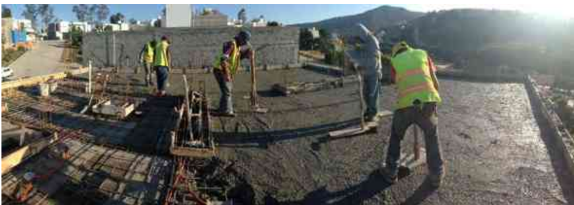
Img. 169 elaboración de losa maciza en obra, fuente: imagen propia del autor. Junio 2017.
