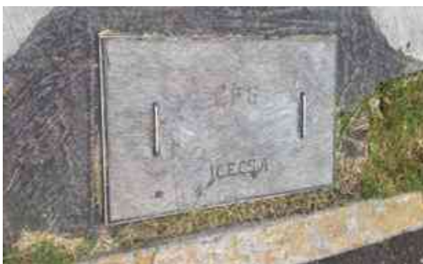
Imágenes del servicio de la CFE sobre Calzada la Huerta Fotografías del autor. Oct. 2015
