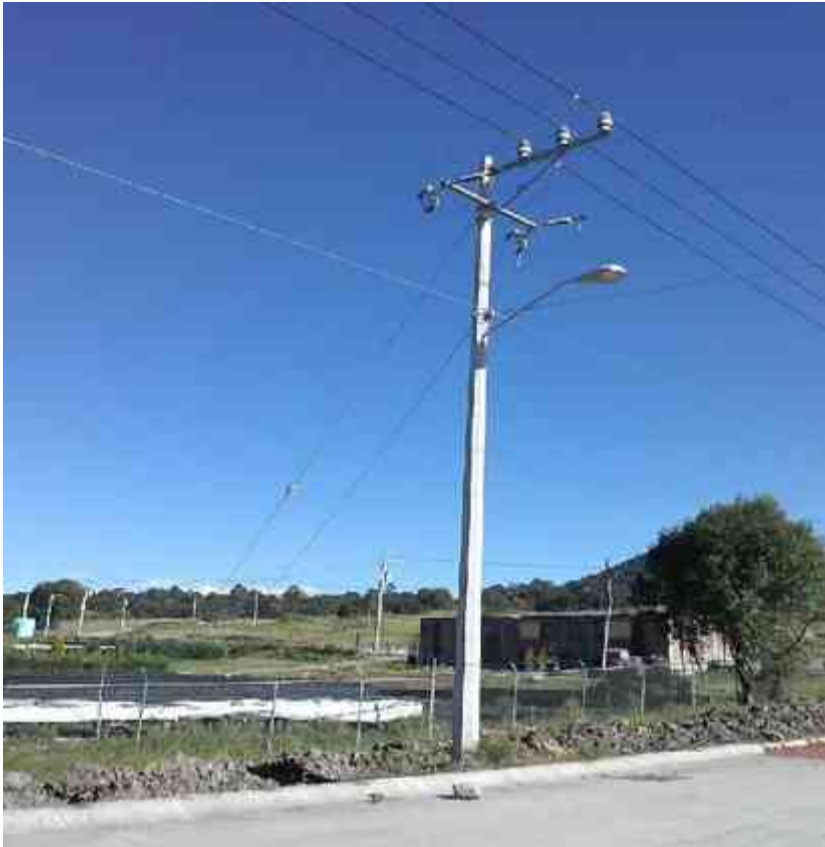
Imagen 5: Alumbrado Público y Servicio Eléctrico. Fuente: Foto tomada por Diego Patiño Suárez. Año: 2012.
