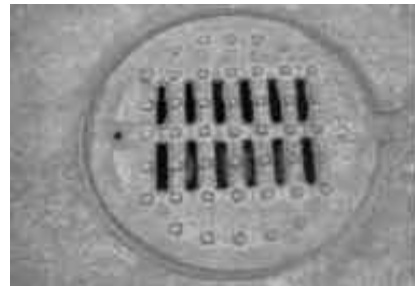
IMAGEN 26.- Registro de Alcantarillado
