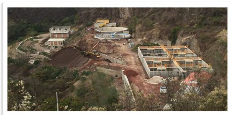
Figura 11. Imagen de la planta tratadora de Cd. Hidalgo.
