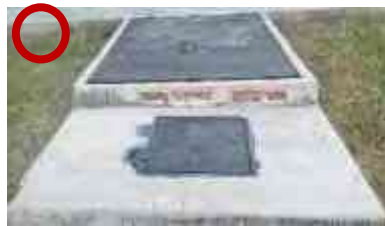
Imagen 29. J. López.: infraestructura
