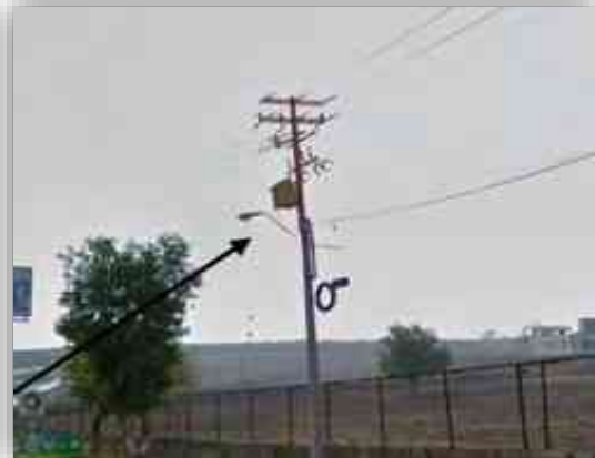
Imagen 96. Infraestructura eléctrica fuente: propia.
