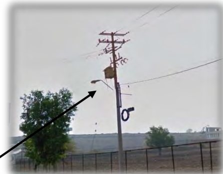
Imagen 65. Infraestructura eléctrica. Fuente. MFVA
