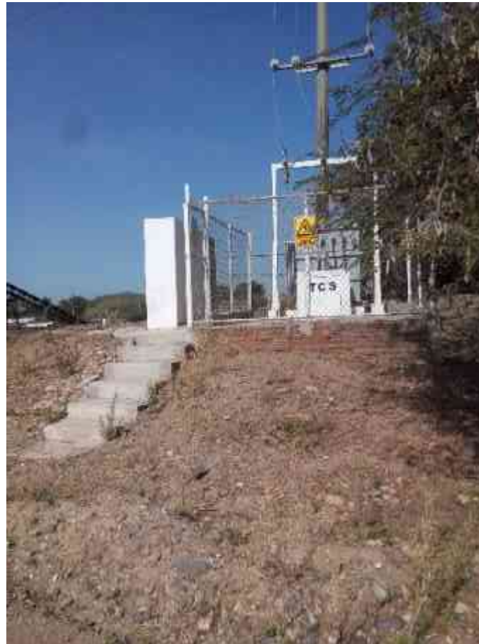
Figura 45. Toma de energía eléctrica. 2016 (Fuente: Autor).
