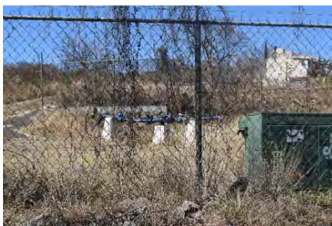
Ilustración #25. Pozo de OOAPAS. Edición propia
