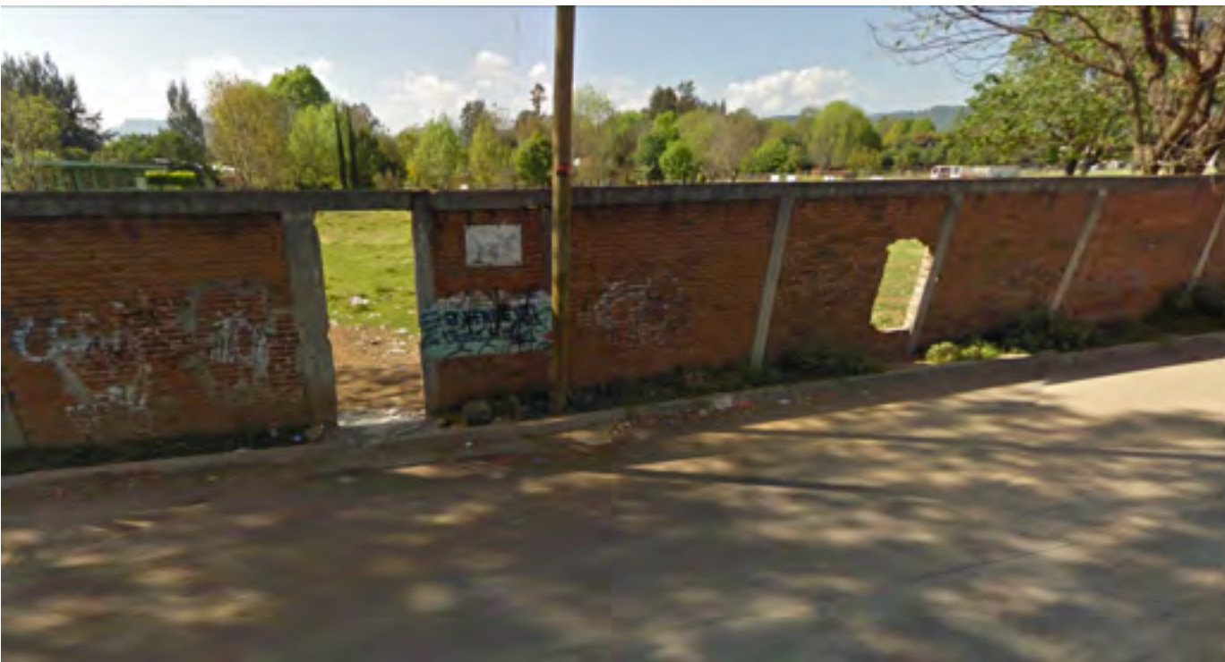
Img. 13.1 Fotografía de daños causados a la extensión de la UMSNH/Juan Luis Manzo
