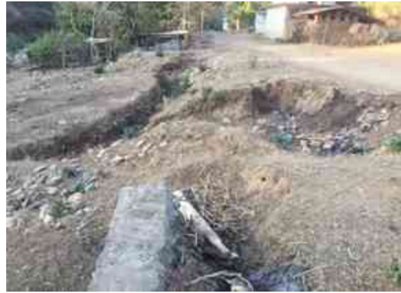
Imagen 03: tramo 1. Desbordamiento de suelos. Fotografía: 20/09/16
