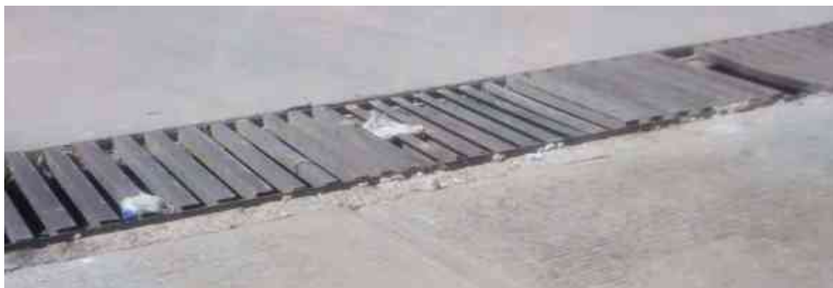
Figura. 25 Fotografía de las condiciones de alcantarillado en el contexto del terreno.
