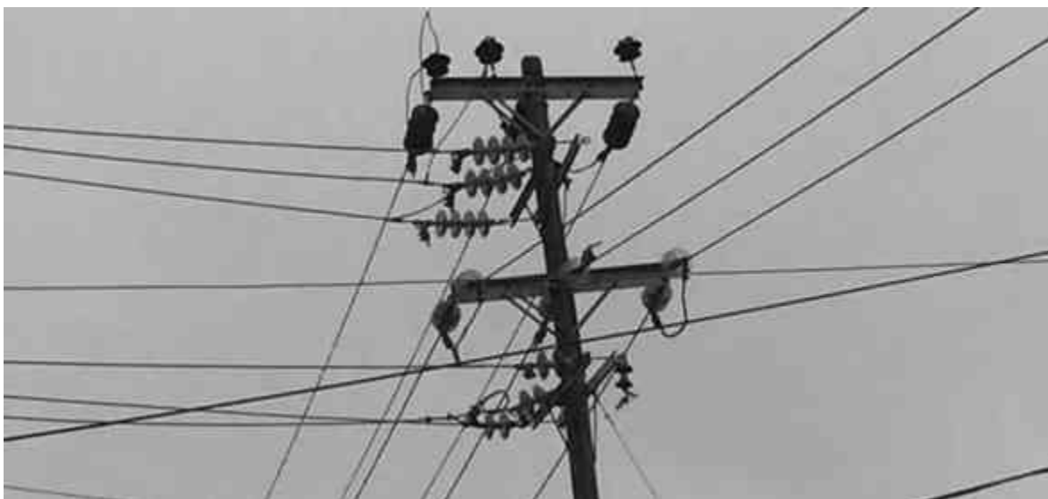
Figura. 26 Instalaciones Eléctricas inmediatas
