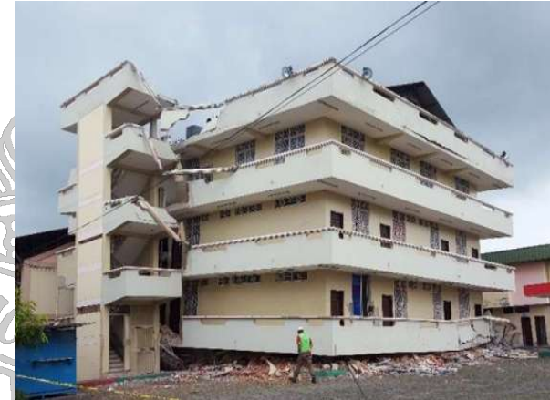
FUENTE: 56 (CENAPRED). (s.f.). Planta baja flexible, piso suave. [Imagen]. Tomada del Acervo fotográfico de la Subdirección de Riesgos Estructurales del CENAPRED
