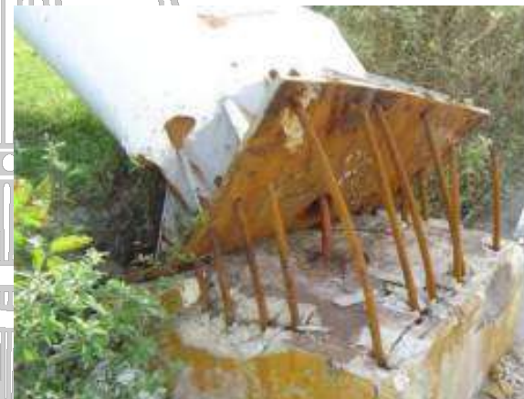
FUENTE: 39 Falla por extracción de las anclas [fotografía].
