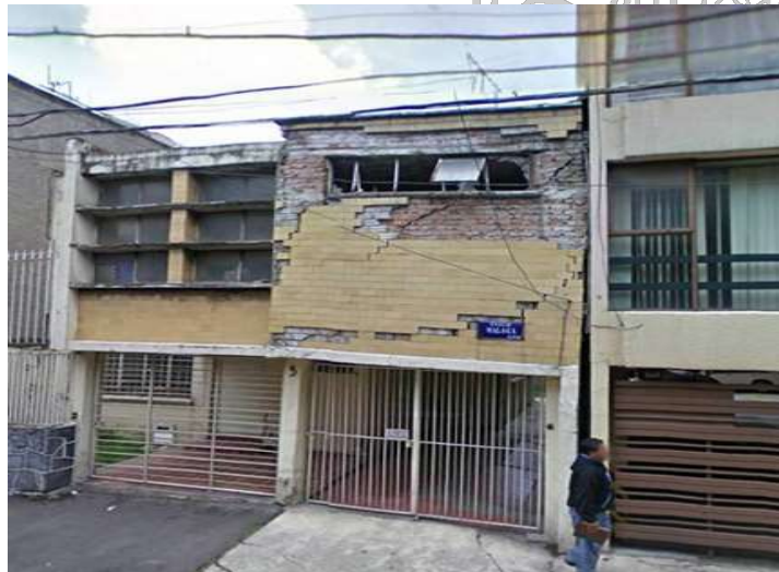
FUENTE: 45 (CENAPRED). (s.f.). Asentamiento del edificio vecino. [Fotografía].
