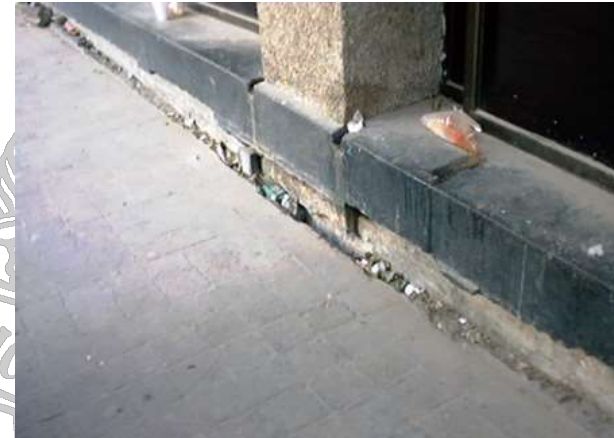
FUENTE: 44 (s.f.). Emersión del edificio. [Fotografía]. Tomada del Acervo de Fotografías y Figuras de la Subdirección de Riesgos Estructurales del CENAPRED
