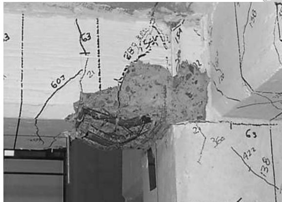
FUENTE: 28 (CENAPRED). (s.f.). Daño por formación de articulación plástica en trabe (daño o falla por flexión). [Fotografía].
