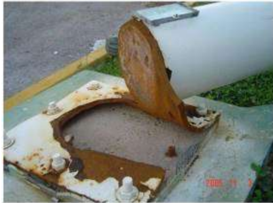
FUENTE: 38 Desgarramiento de la placa base [fotografía]. Tomada de Acervo de Fotografías y Figuras de la Subdirección de Riesgos Estructurales del Cenapred.
