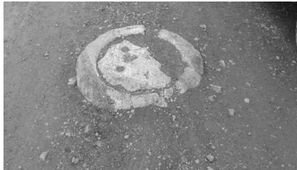
Ilustración 13 alcantarillado en la calle del terreno foto: Erik Rafael López Hernández
