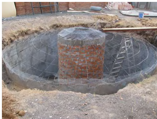
Imagen 118. Muro Filtrante de tabique en cisterna de Ferrocemento
