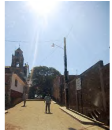
Imagen 32 Poste de luz de la Comisión Federal de Electricidad CFE en Zirahuén
