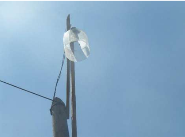
Fig.66 Luminaria improvisada en una de las Canchas de Básquetbol, del Parque Lineal Bicentenario. Ubicada en uno de los asentamientos irregular a un costado del Estadio Morelos. Foto: Landy Janeth Zárate Martínez
