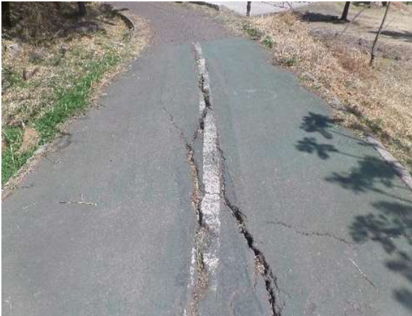
Fig.52 Grietas de la Ciclo Pista, tramo ubicado a espaldas del Estadio Morelos.
