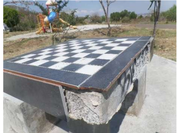
Fig.65 Mesa de concreto de una de las áreas de descanso del Parque Lineal Bicentenario, con desprendimiento de material y presencia de vandalismo. Foto: Landy Janeth Zárate Martínez
