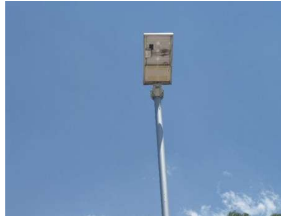
Fig.67 Una de las luminarias del Parque Lineal Bicentenario, descompuesta. Foto: Landy Janeth Zárate Martínez
