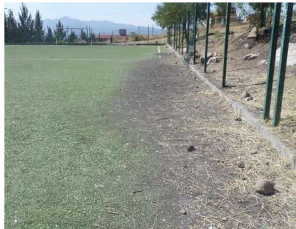
Fig.59 Presencia de deslaves en la cancha de Fútbol.
