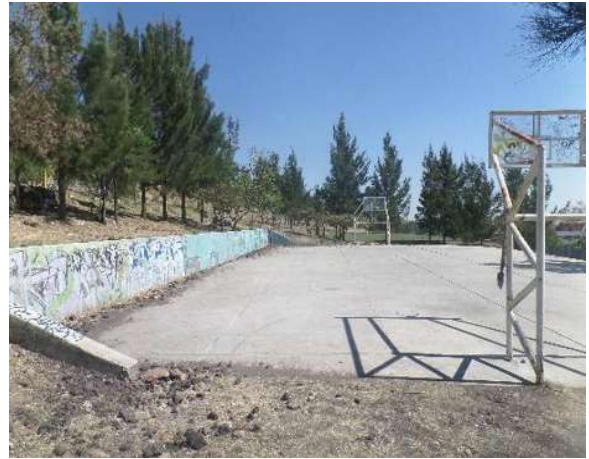
Fig.61 Cancha de Básquetbol con presencia de bandaluzismo y deslaves en sus extremos. Ubicada a espaldas del Estadio Morelos. Foto: Landy Janeth Zárate Martínez Fecha: febrero 2018
