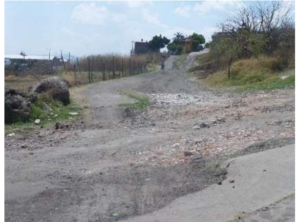
Fig.55 Tramo totalmente cortado del Parque Lineal Bicentenario. Ubicado en la calle Leandro Valle.
