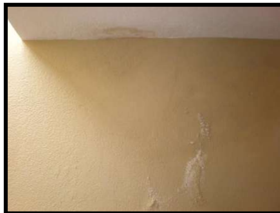
Figura 28 El agua penetra en muros plafones ya sea por filtración capilaridad etc. Y así deteriora si no hay cuidado y será más costosa la reparación. <<Tomada por JFR>> Consultada el 18.12.2017.
