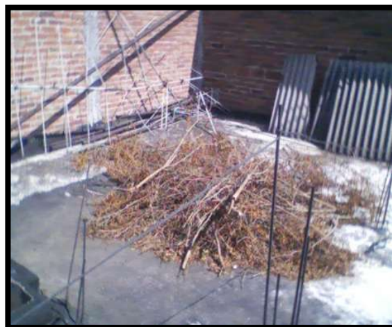
Figura 31 Azotea sucia retirar todo para poder impermeabilizar. <Tomada por JFR> Consultada el 23.12.2017
