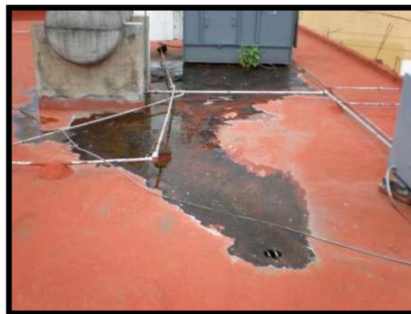
Figura 25 Al no dar mantenimiento a azoteas y equipos de aire, extractores etc., es muy común estos casos y provocara la degradación y humedad con el tiempo.<<Tomada por JFR>> Consultada el 20.12.2017.
