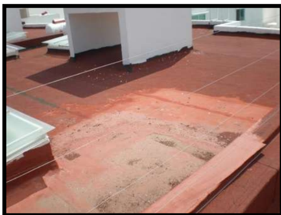
Figura 26 Observar cuando hay mal uso de una azotea como hacer mezclas dejar objetos pesados provocara fallas más las malas reparaciones. <<Tomada por JFR>> Consultada el 20.12.2017.
