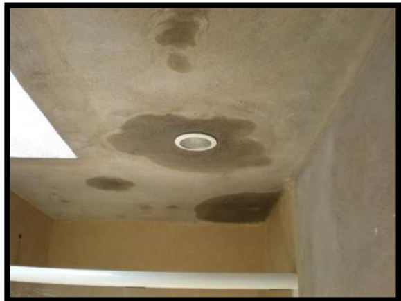
Figura 27 Se observa la filtración del agua en el plafón muestra de que hay grieta o encharcamiento en azotea. <<Tomada por JFR>> Consultada el 18.12.2017.
