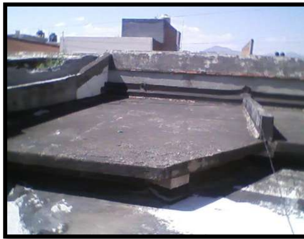
Figura 30 Azotea sin bajadas con impermeabilizante degradado y topes muy irregular. <Tomada por JFR> Consultada el 23.12.2017
