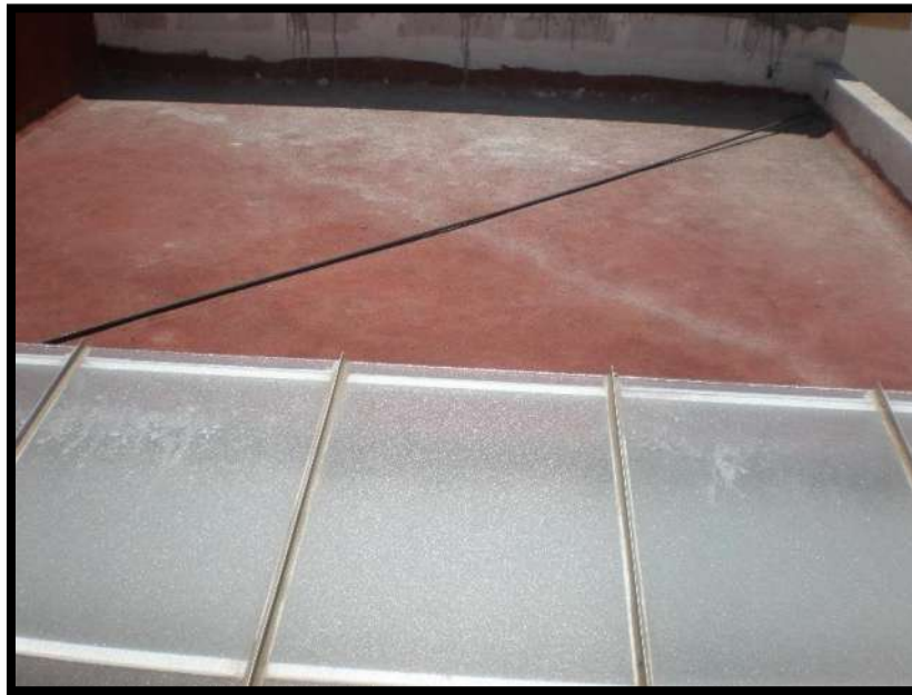
Figura 23 Esta azotea muestra que se encharco el agua es la probabilidad por lo que tienen humedades es uno de los puntos que se revisa. <<Tomada por JFR>> Consultada el 20.12.2017
