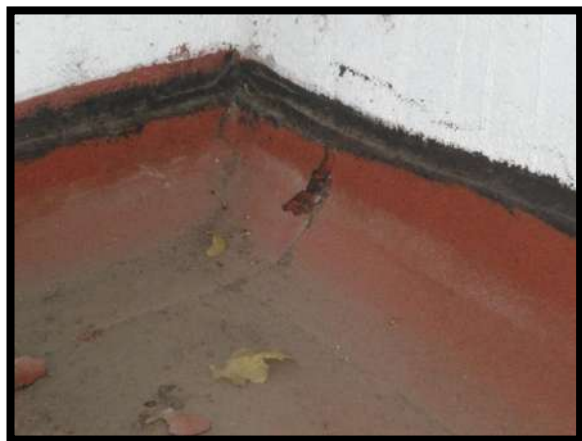
Figura 24 Otra observación en azoteas es la falta de mantenimiento basura y suciedad que obstruye las bajadas. <<Tomada por JFR>> Consultada el 17.12.2017.
