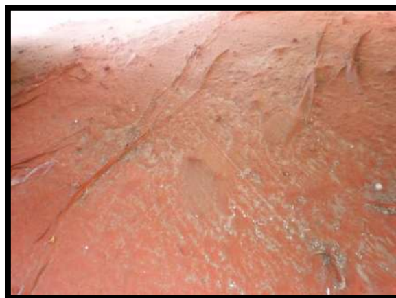
Figura 36 Observar la mala colocación de la tela con arrugas Impermeabilización. <Tomada por JFR>. Consultada el 12.12.2017
