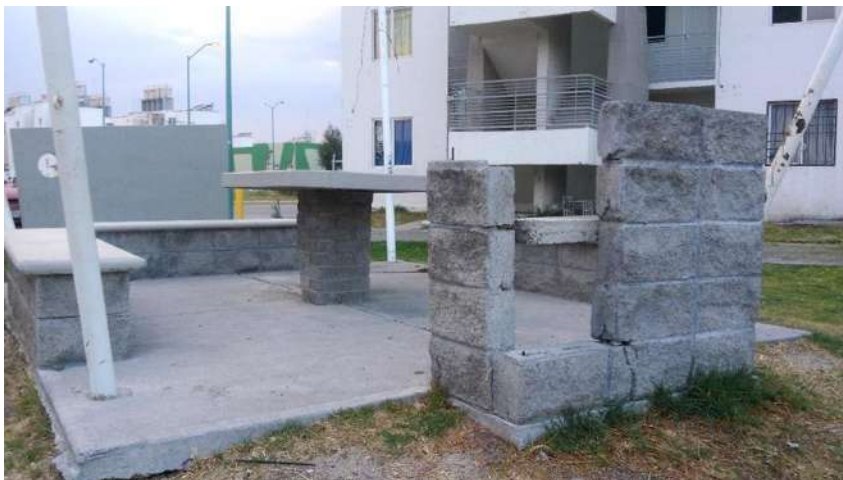
Imagen 49: el asador del quiosco en J1 fue parcialmente destruido, dado que el asador perdió varios de los bloques que conformaban una de sus esquinas. Fuente: Autor. Fecha de captura: 04/abril/2018.
