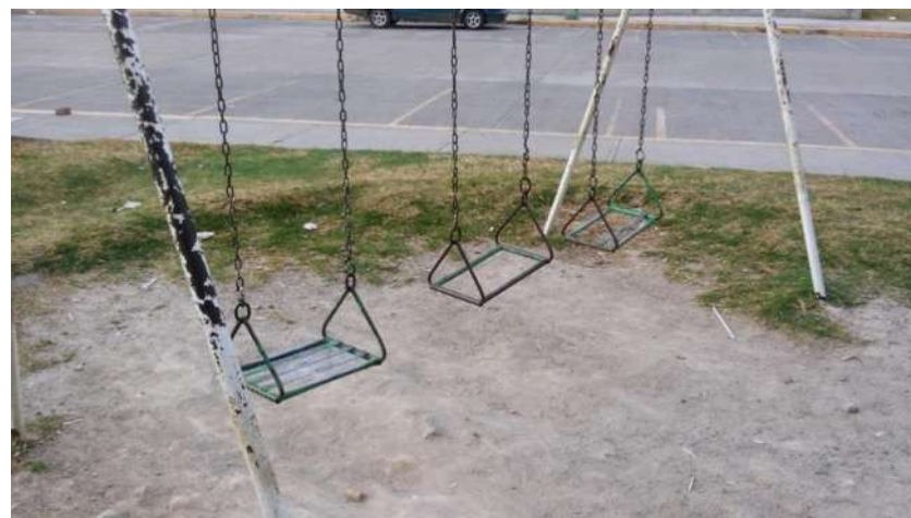
Imagen 25: los columpios ubicados en J4 se encuentran en malas condiciones, dado que a decir de los residentes, son golpeados constantemente entre sí, ocasionando que la solera metálica de la que estaban hechos los asientos se desprendiera. Fuente: Autor. Fecha de captura 13/febrero/18.
