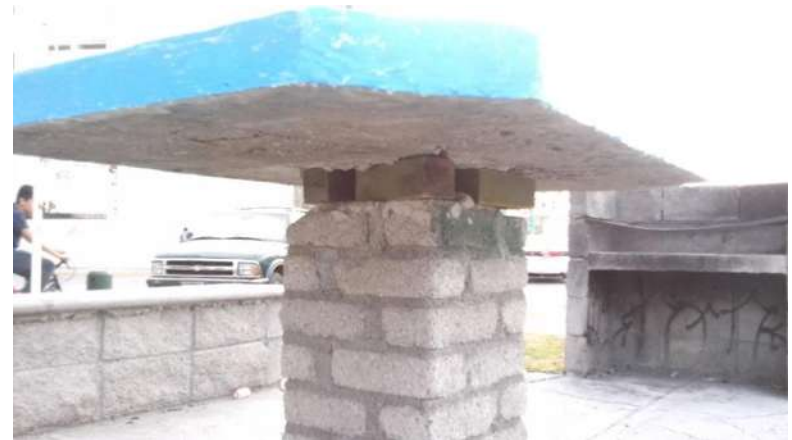
Imagen 63: la mesa en el quiosco oeste fue reparada por los residentes mediante la colocación de polines como refuerzo de la estructura. Fecha de captura: 03/marzo/2018.
