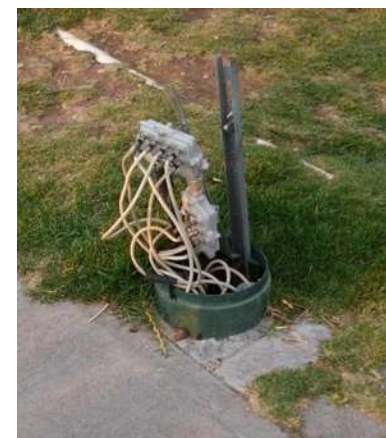
Imagen 50: registro de concentración de datos cuya tapa fue destruida y ha dejado la instalación vulnerable ante el clima y la vida cotidiana del condominio. Fuente: Autor. Fecha de captura: 03/marzo/2018.
