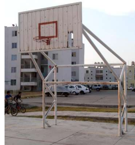
Imagen 55: detalle de poste-portería en cancha de J3, la cual presenta el tablero roto y partes metálicas con pintura desgastada y óxido. Fecha de captura: 04/abril/2018.
