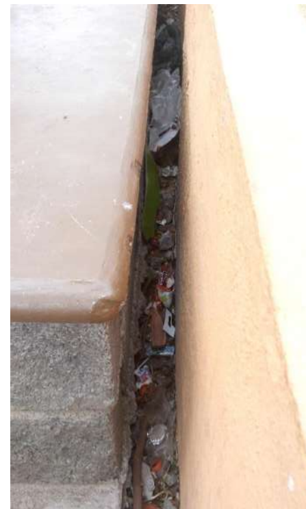
Imagen 98: detalle de quiosco norte, en el cual se acumula la basura entre el muro que lo limita y el asiento. La constructora da mantenimiento a las áreas, pero esta imagen permite concluir que los habitantes tiran basura de forma regular en los quioscos. Fuente: Autor. Fecha de captura: 25 /febrero/2018.
