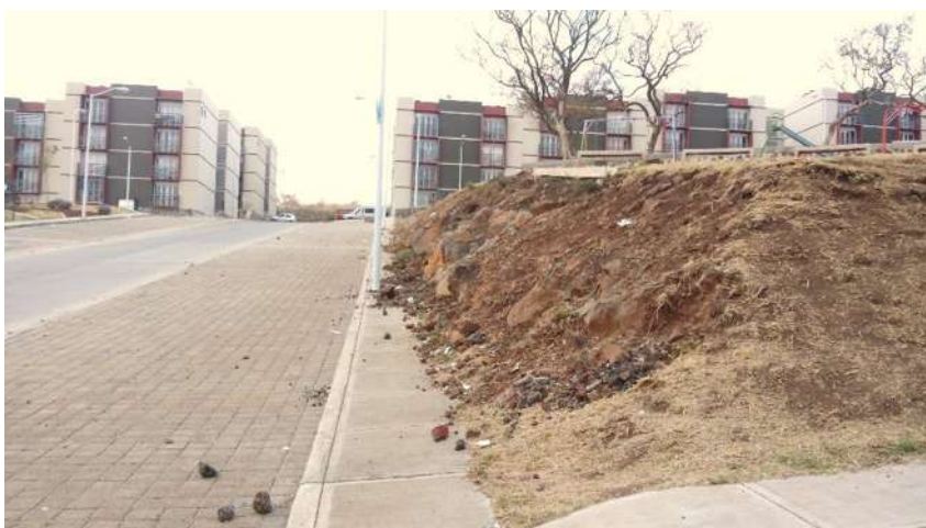
Imagen 76: el talud de pasto que forma parte de la zona A se está destruyendo, dado que la malla que sostenía al pasto se está cayendo, dejando que las piedras que forman la plataforma caigan al estacionamiento. Fuente: Autor. Fecha de captura 26/feb/18.
