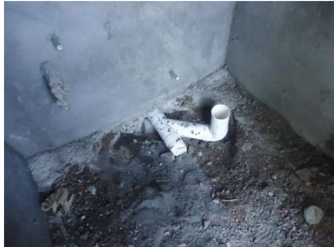
Imagen #37.- Salida sanitaria en baño 2" Autor: (JAVAR).
