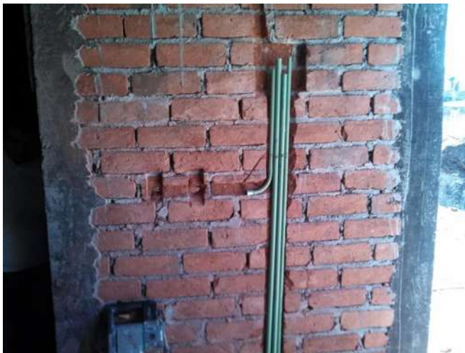
Imagen #38.- Tubería conduit PVC tipo ligero de 1/2" para conectar a centro de carga, Autor (JAVAR).
