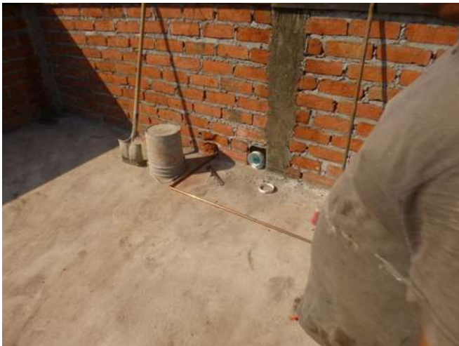
Imagen #34.- Tubería de cobre (Cu) tipo "M" ½", Autor:(JAVAR)
